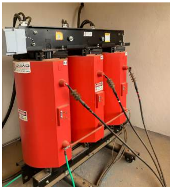
Figura 9 - Transformador a seco 1250kVA.
