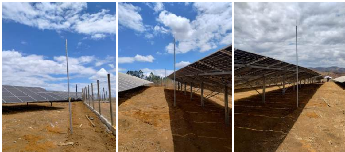
Figura 18 (a,b,c) - Disposição dos mastros instalados na Usina Fotovoltaica.
