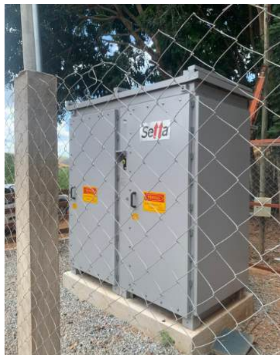
Figura 10 - Cabine de medição e proteção.
