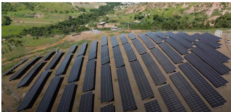
Figura 13 - Vista Lateral da Usina Fotovoltaica.
