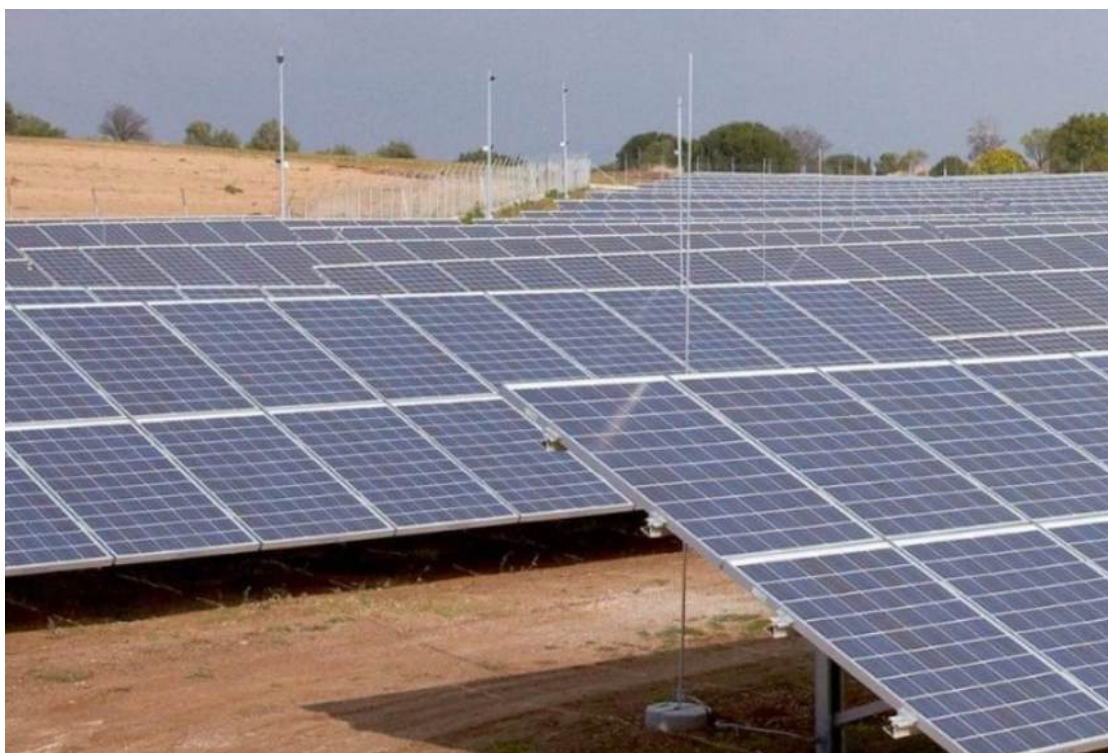
Figura 6 - Uso de mastros livres para proteção contra descargas.
