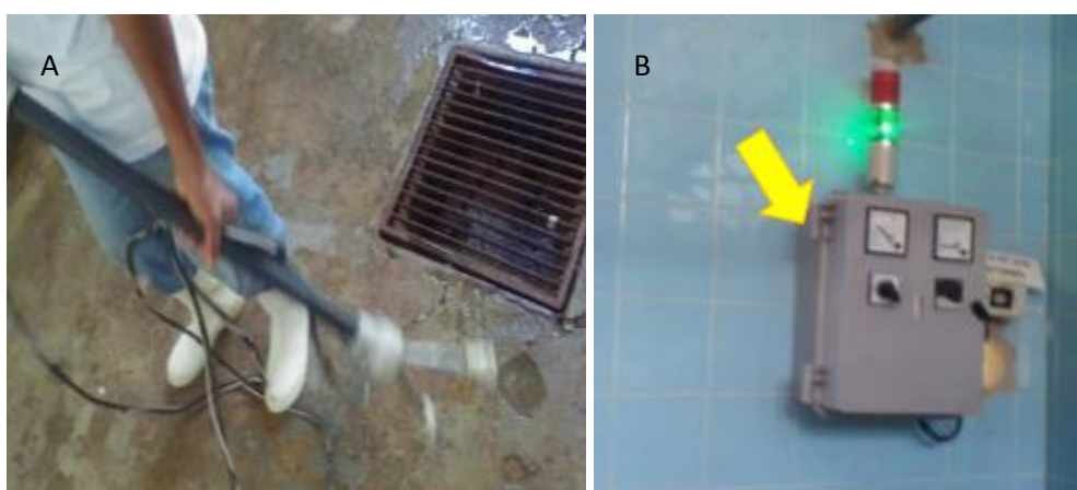
Figura 4: A) Atoroador elétrico. B) Painel de controle do atoroador.
