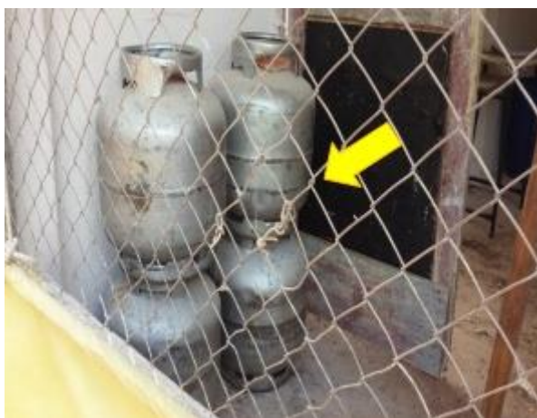
Figura 65: Armazenamento inadequado do gás de cozinha.
