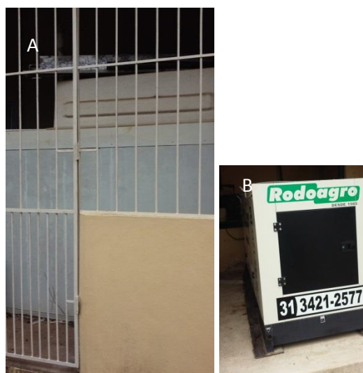
Figura 37: A) Vista externa da câmara fria B) Gerador
