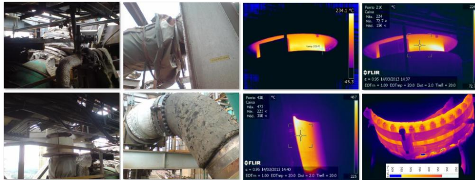
Figura 07 – Análise termográfica industrial (Termografia Butterfly Valves ).
