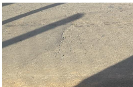
a) Fissura – Estaca 2
