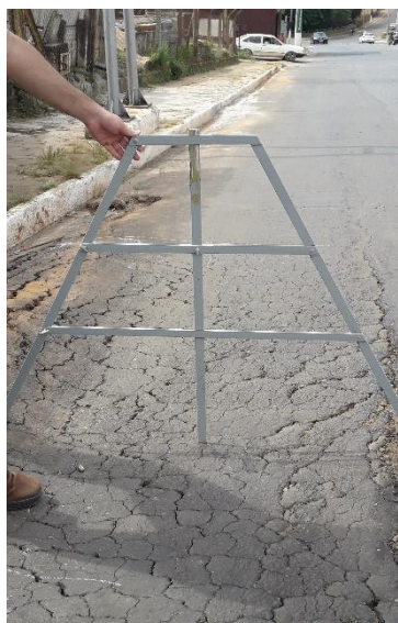
a) Afundamento – Estaca 2
