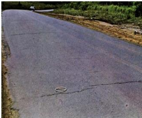
Figura 4 - Trincas Isoladas Transversais
