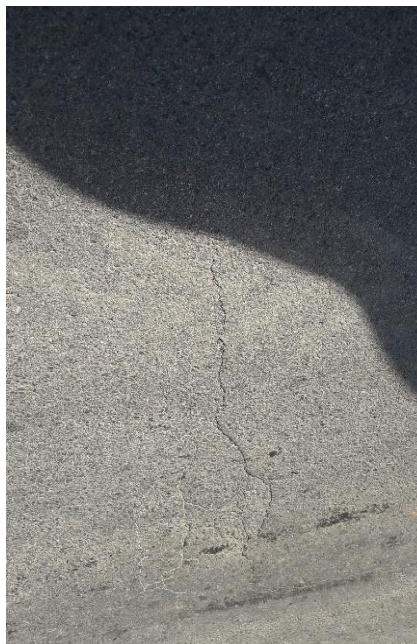
d) Trinca Transversal – Estaca 20
