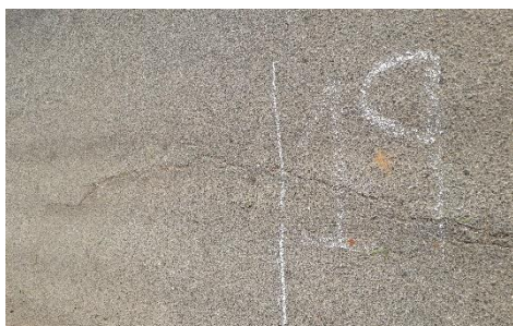
b) Trinca Longitudinal – Estaca 19
