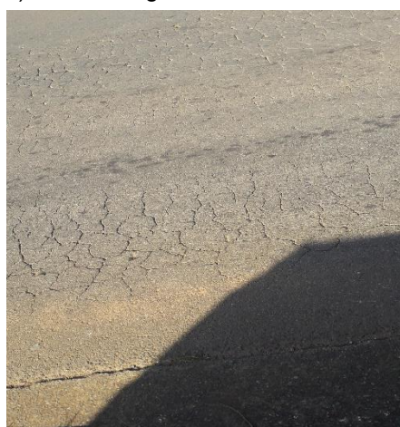
c) Trinca "Jacaré" – Estaca 6
