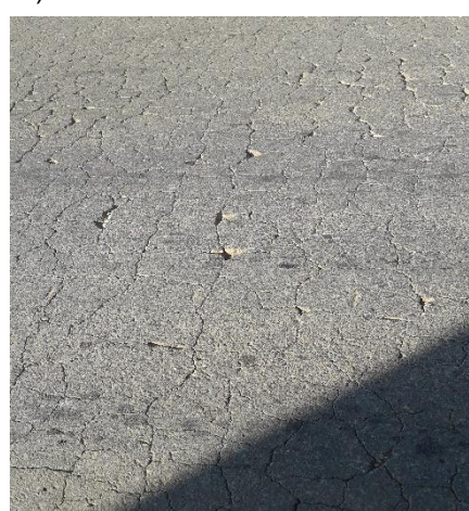
e) Trinca "Jacaré" com erosão acentuada – Estaca 8
