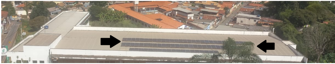
Figura 18 – Arranjos de placas fotovoltaicas – IFMG Campus Itabirito
