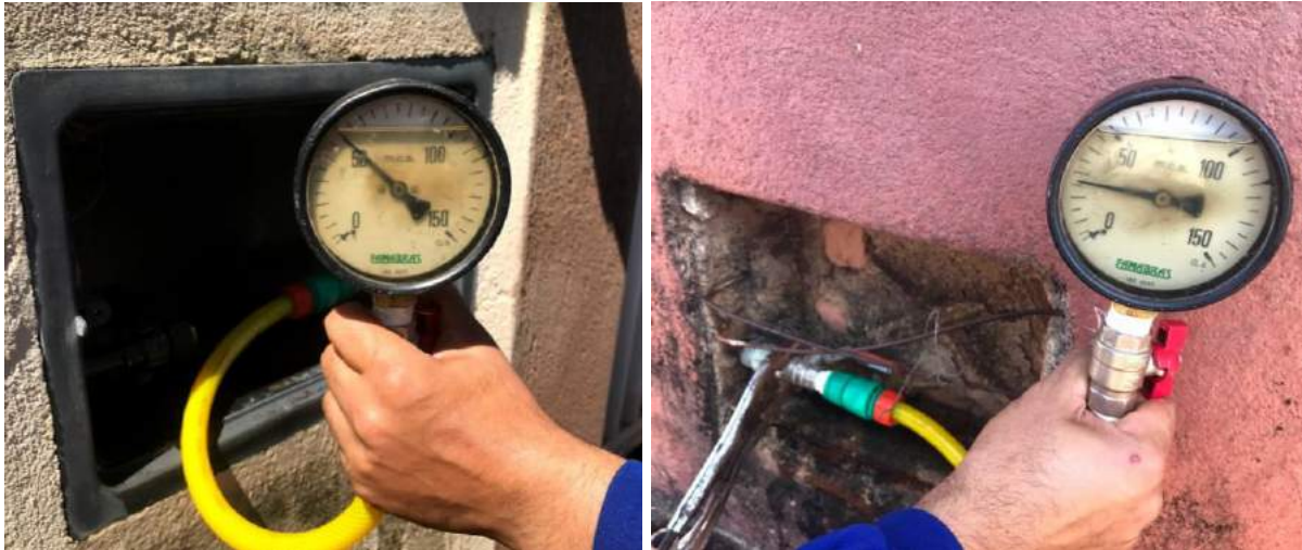
Figura 19 – Manômetro instalado em cavaletes residenciais.
