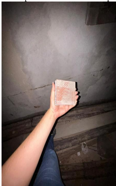
Figura 16 - Corpo de prova CP3 do painel não normatizado após ensaio de aderência à tração
