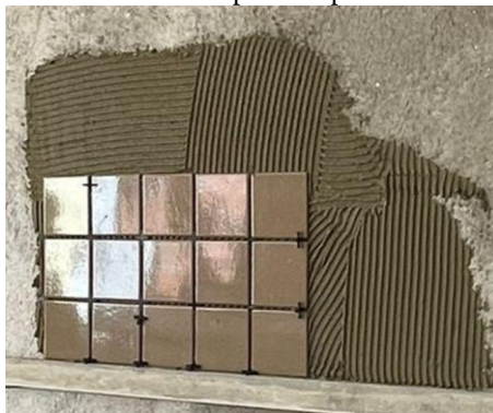
Figura 5 - Assentamento de pastilha painel não normatizado
