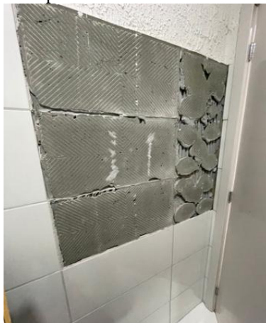
Figura 1 - Desplacamento em revestimento cerâmico
