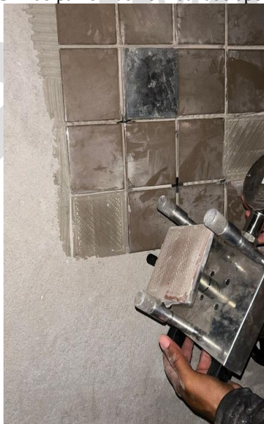
Figura 15 - Corpo de prova CP2 do painel não normatizado após ensaio de aderência à tração
