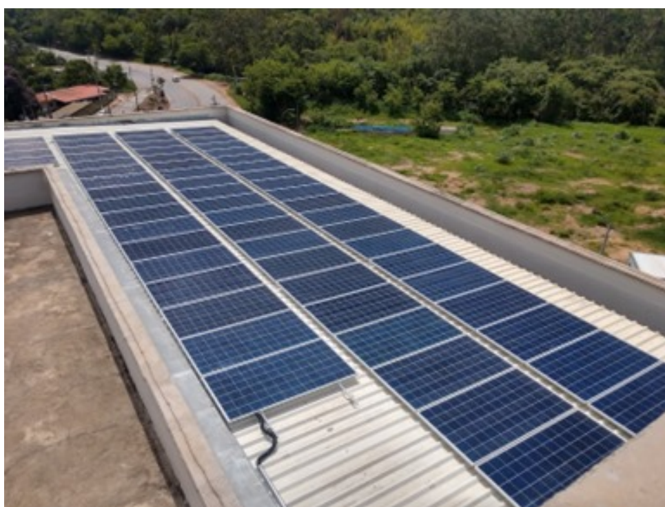
Figura 5 – Painéis solares existentes (tenda)
