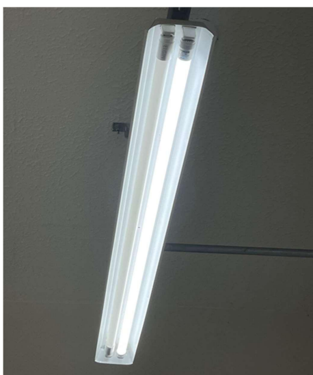
Figura 33 - Lâmpada in loco com defeito.
