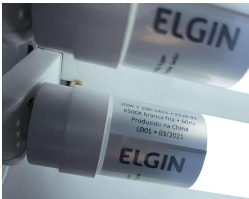
Figura 20 - Lâmpadas atualmente instaladas na sala de aula.
