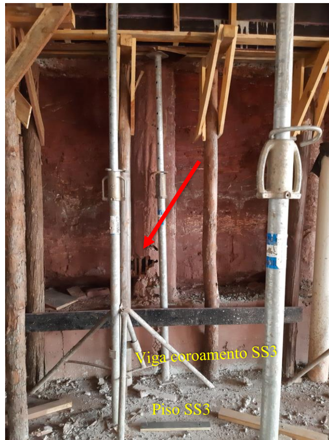
Figura 16 – Estaca 3 executada, com vazio em seu interior
