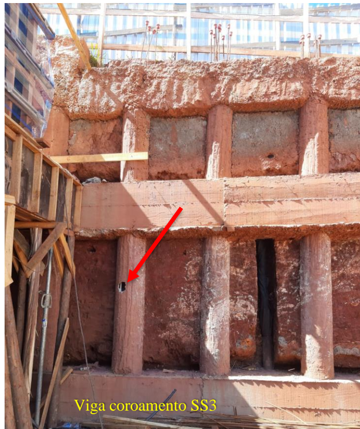
Figura 12 – Estaca 1 executada, com vazio em seu interior
