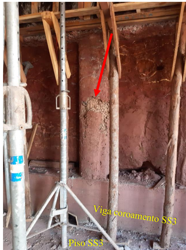
Figura 14 – Estaca 2 executada, apresentando “ninhos” de concretagem
