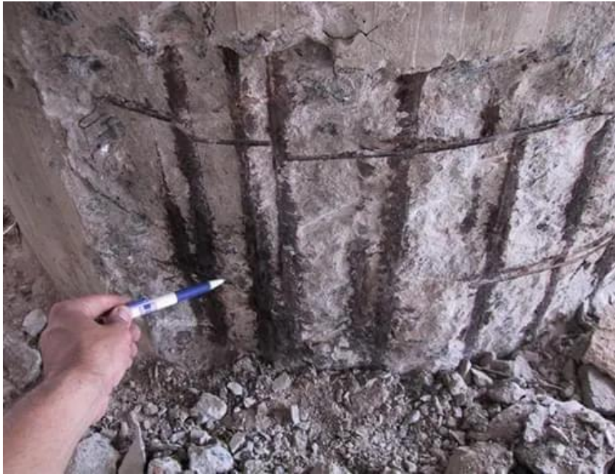
Figura 8 – Concreto com corrosão avançada e armadura exposta
