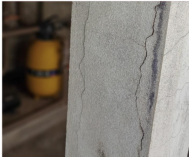
Figura 6 – Fissuras verticais em pilar causadas pela expansão das armaduras longitudinais
