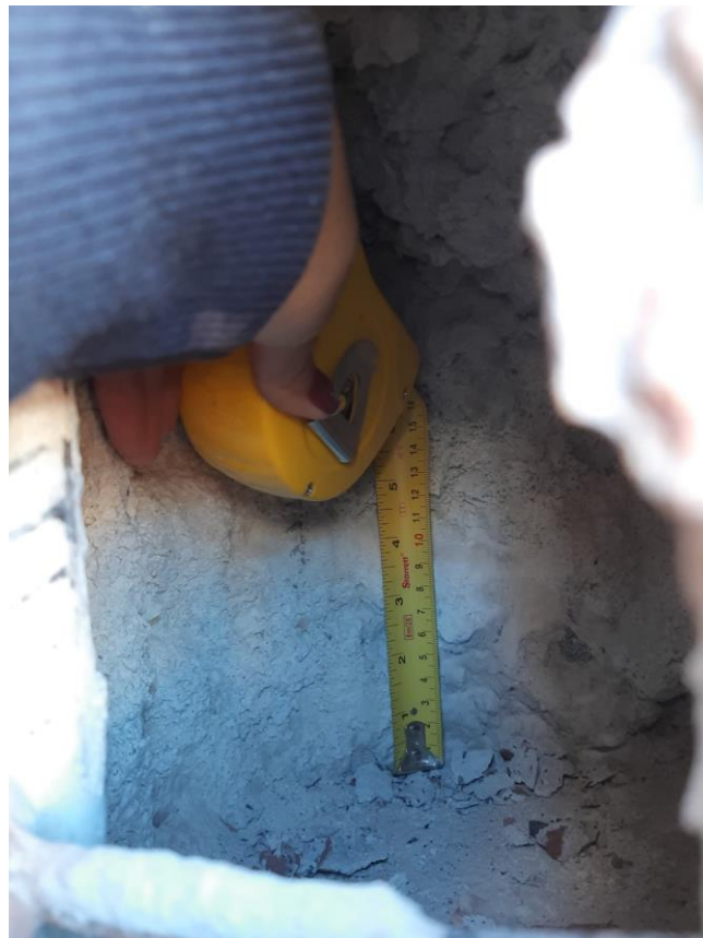
Figura 19 – Identificação da altura do vazio de concretagem
