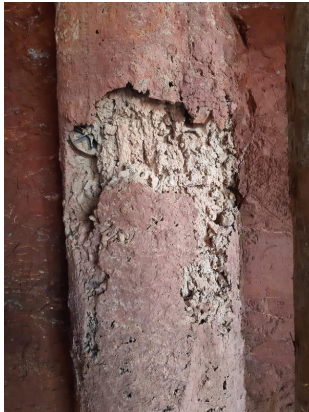
Figura 21 – Estaca 2: “ninho” de concretagem (“bicheira”)
