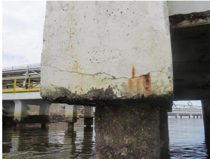
Figura 7 – Mancha superficial devido a corrosão da armadura por íons de cloreto
