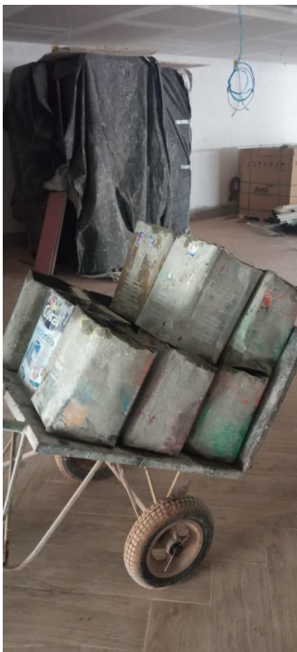
Figura 15 - Transporte Horizontal (parte superior do edifício).
