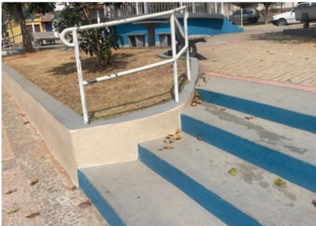
(c) Escada com corrimão (nota-se a falta de piso tátil)
