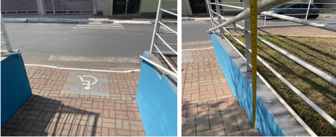
c) Detalhe da faixa de pedestre em mal estado de conservação
