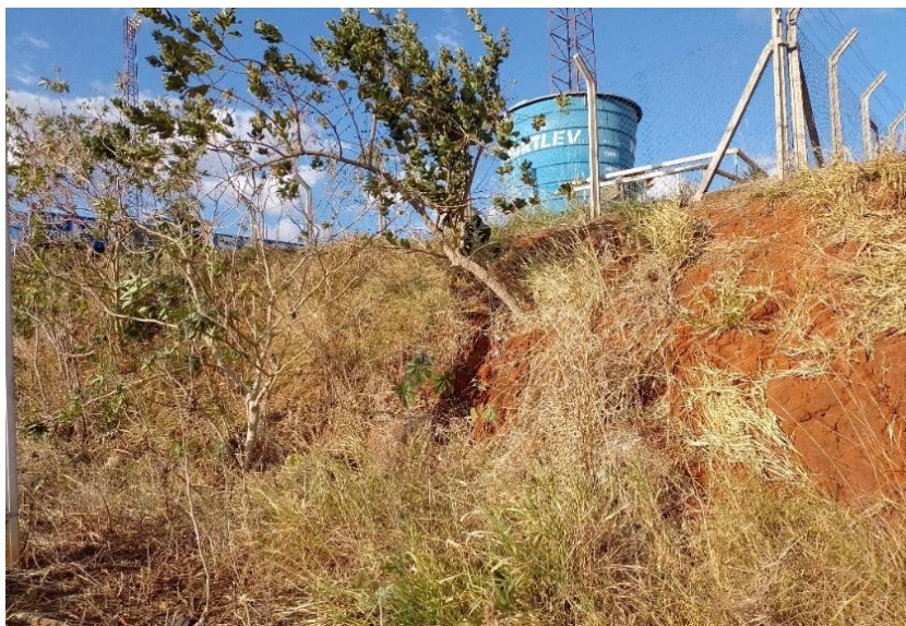
Figura 41 - Árvore inclinada no talude
