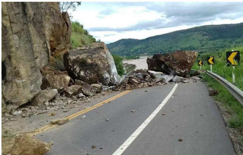
Figura 8 - Quedas de blocos no trecho da BR 259 em Colatina-ES
