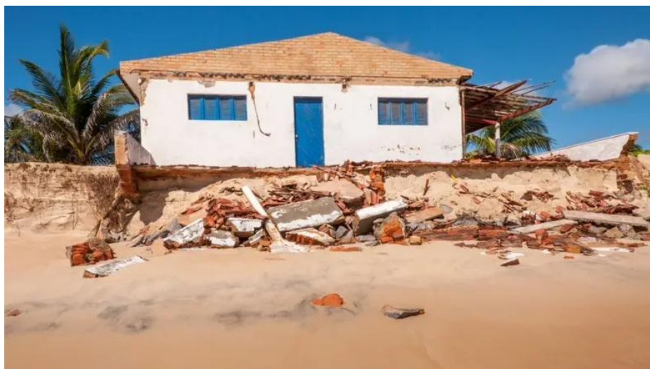
Figura 29 - Erosão marítima em Natal - RN
