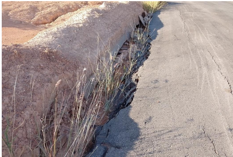
Figura 57 - Trecho da rua do meio-fio destruídos
