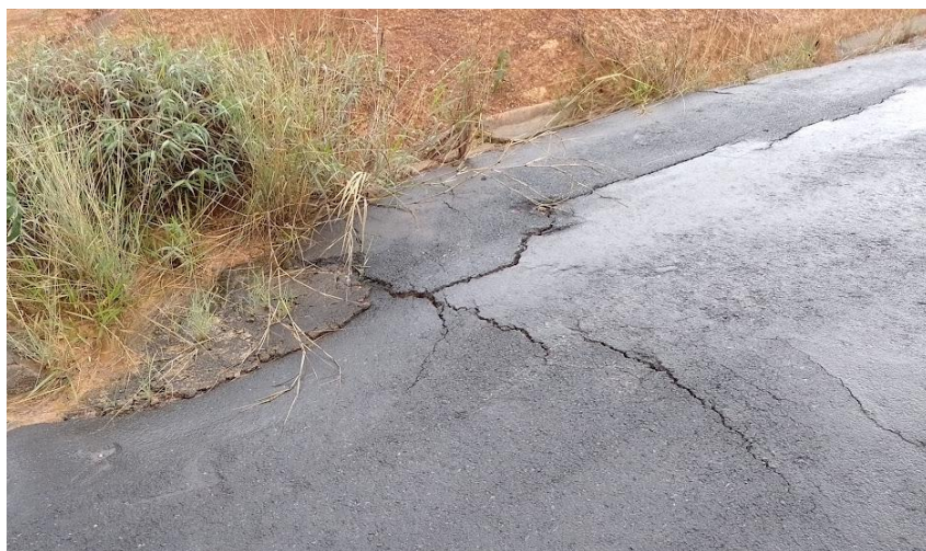
Figura 52 - Rachadura na rua
