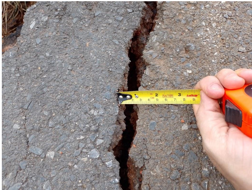
Figura 53 - Medição da rachadura na rua
