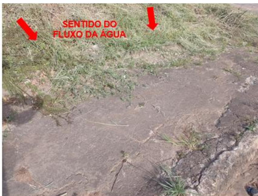
Figura 73 - Trincas no passeio
