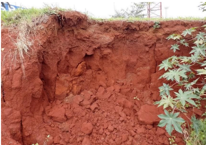
Figura 42 - Depósitos de solo no pé do talude
