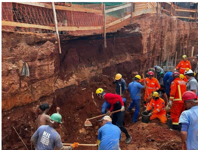
Figura 6 - Escorregamento induzido em obra em Belo Horizonte – MG
