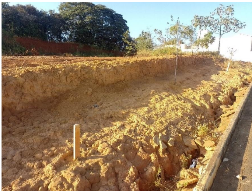
Figura 81 - Desnível e trincas no solo
