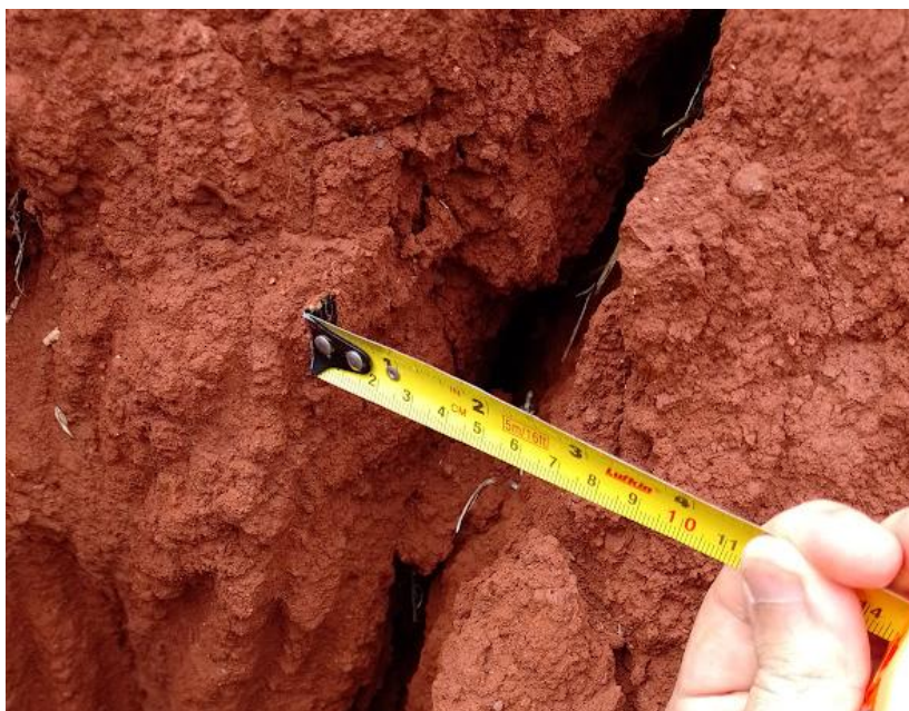
Figura 40 - Tamanho da trinca do talude do Ponto 1
