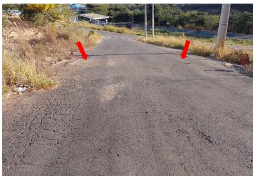
Figura 65 - Recalque na rua
