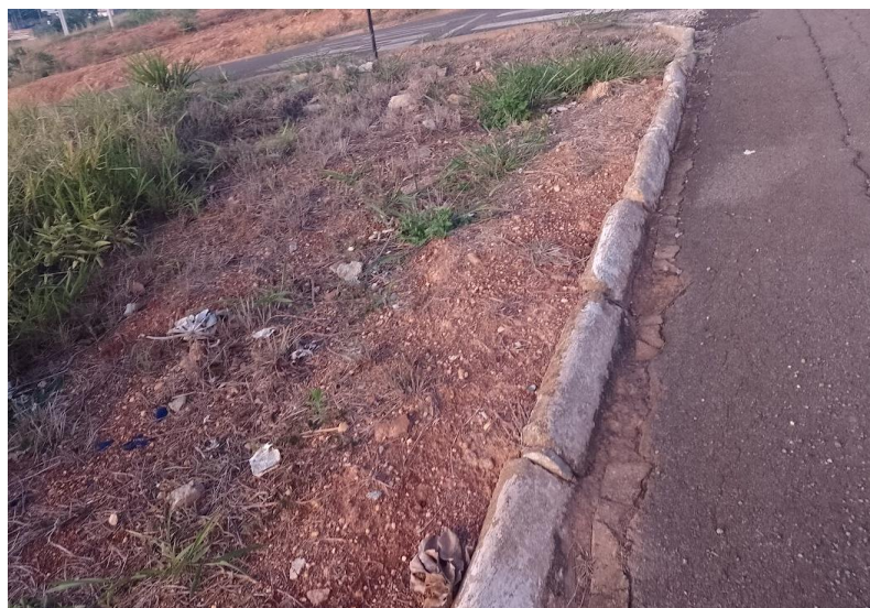
Figura 75 - Meio-fio danificado do Ponto 4
