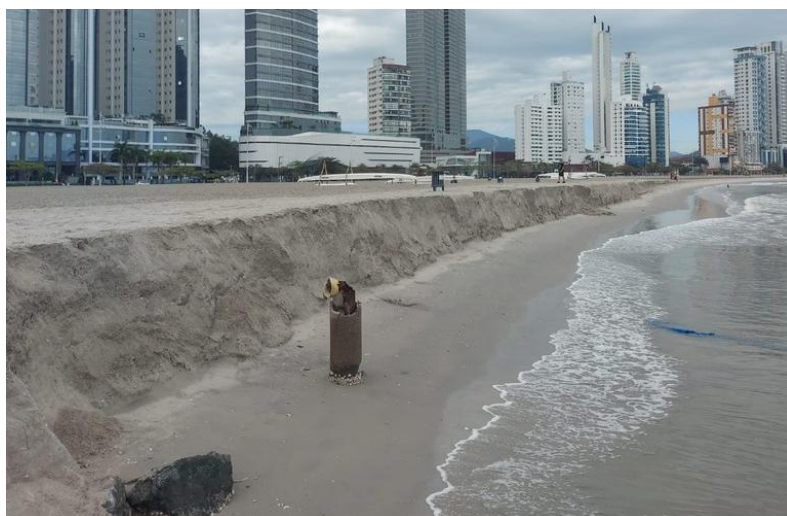
Figura 14 - Erosão em Balneário Camboriú - SC
