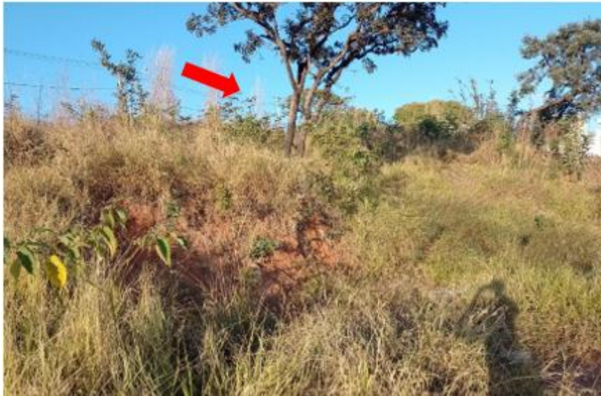
Figura 62 - Árvore inclinada no Ponto 3
