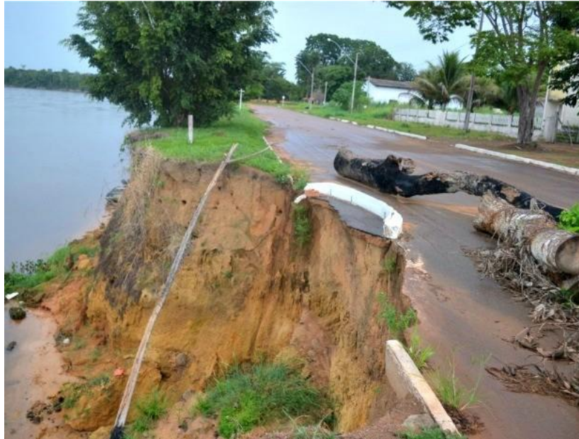
Figura 28 - Avenida afetada por erosão em margem de rio
