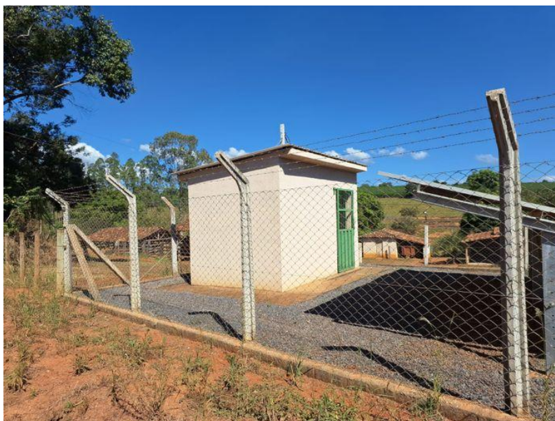
Figura 27 — Casa de inversores
