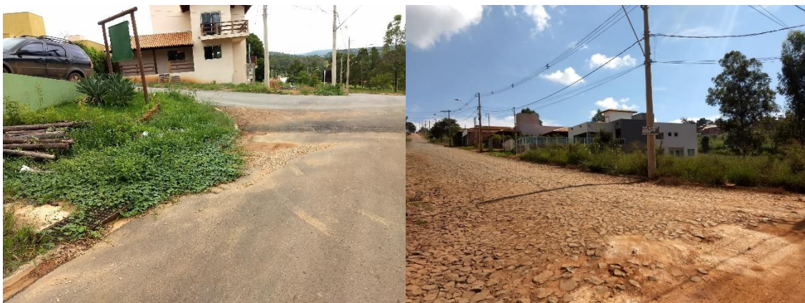
Figura 51 – Loteamento sem Sinalização Vertical e Horizontal.
