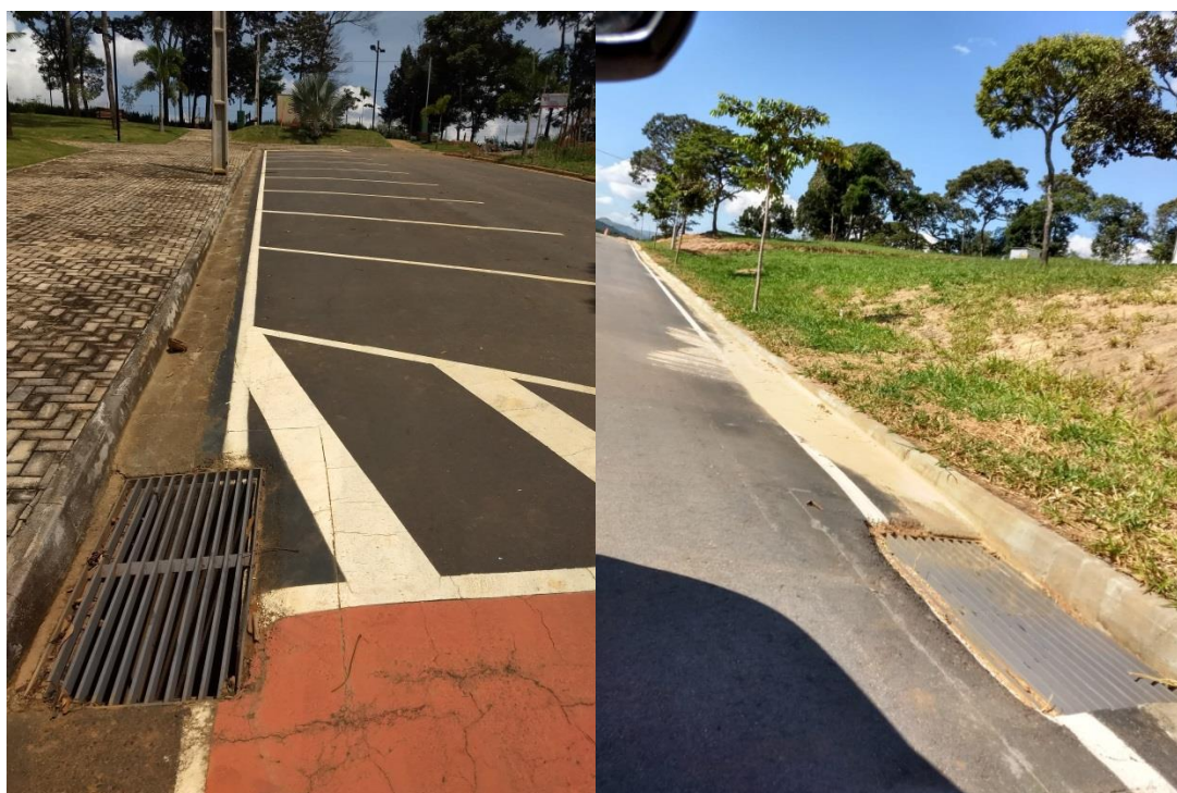
Figura 32 - Bocas de Lobo e Sarjetas.
