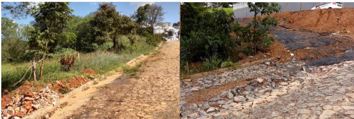
Figura 48 - Guias de meio fio danificadas e calçamento solto.
