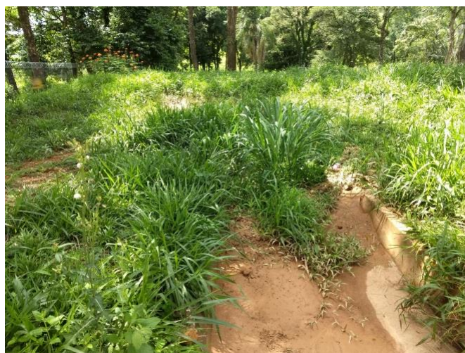
Figura 34 - Canal de condução assoreado e presença de vegetação.
