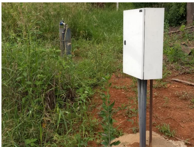
Figura 52 - Poço tubular profundo e caixa de energia.
