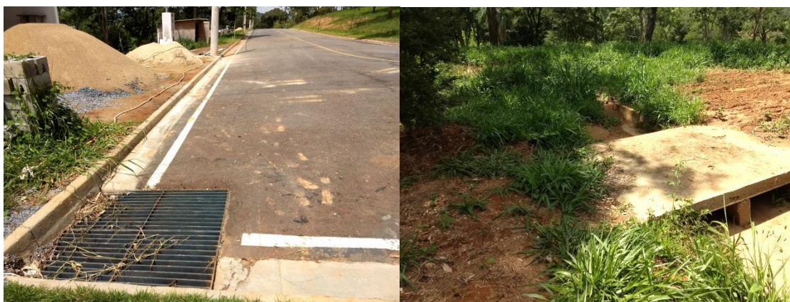
Figura 33 - Bocas de Lobo e Caixas de Captação.
