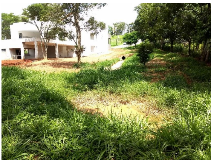
Figura 35 - Sistema de Drenagem e barragem de contenção.
