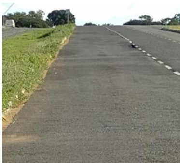
Figura 8: Pista com asfalto irregular
