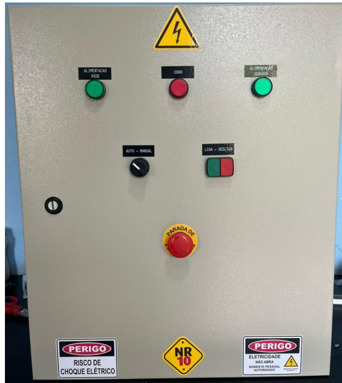
Figura 13 – Painel elétrico conforme NR10.
