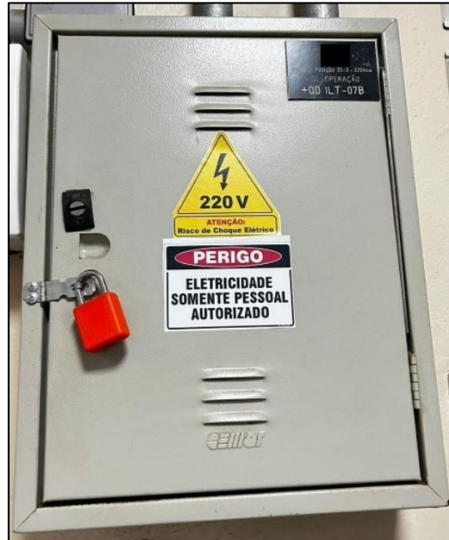
Figura 34 - Sinalização de restrições e impedimento de acesso a quadros elétricos
