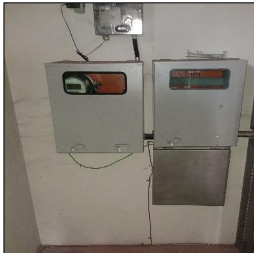
Figura 13 - Medidor de energia
