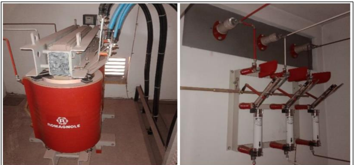
Figura 16 - Transformador a Seco Romagnole e chave seccionadora com fusível
