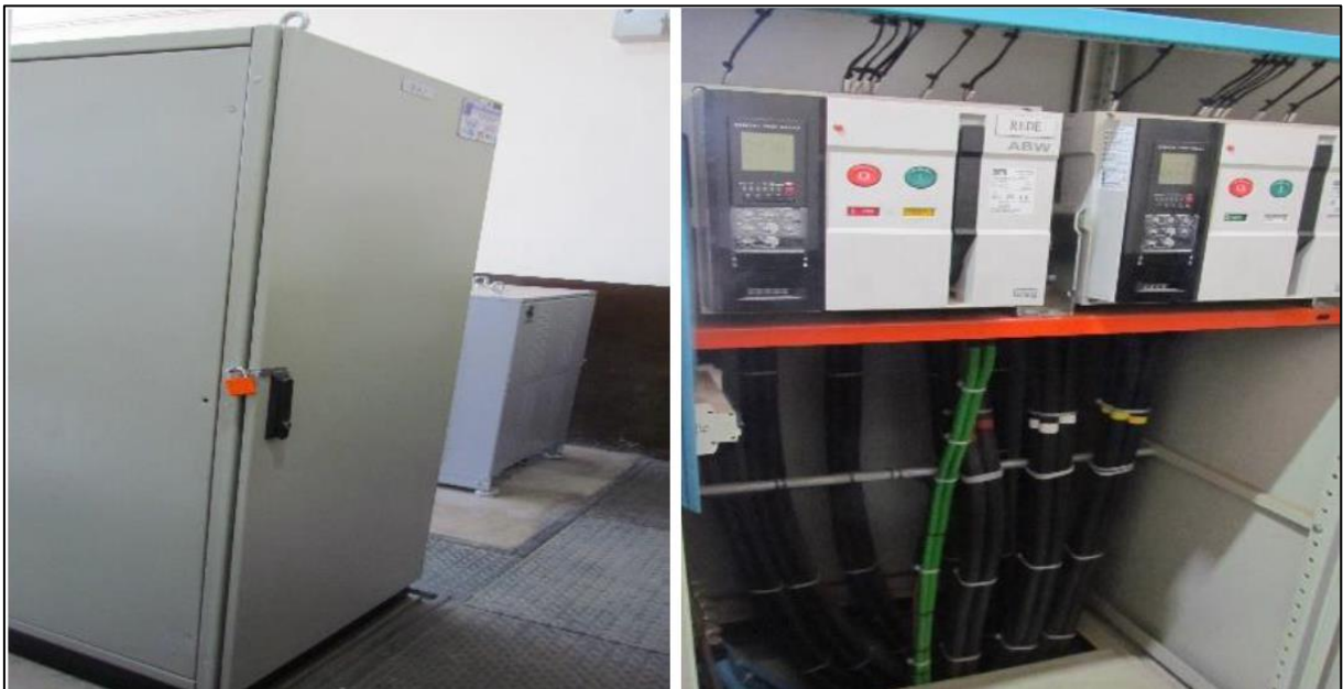
Figura 19 - Quadro de transferência automática (QTA)
