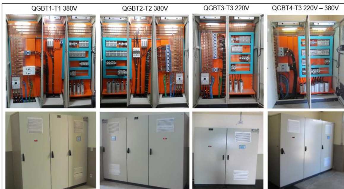
Figura 20 - Quadros gerais de baixa tensão (QGBTs)
