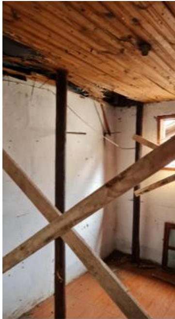
Imagem 20: Pavimento superior, um dos quartos da casa, piso cerâmico, intervenção inadequada, forro de pinus com visível ataque de insetos xilófagos, 02/2023
