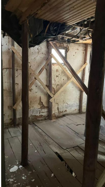
Imagem 22: Pavimento superior, quarto, alvenaria em pau a pique, forro de pinus com visível ataque de insetos xilófagos, piso de madeira em mau estado, 02/2023
