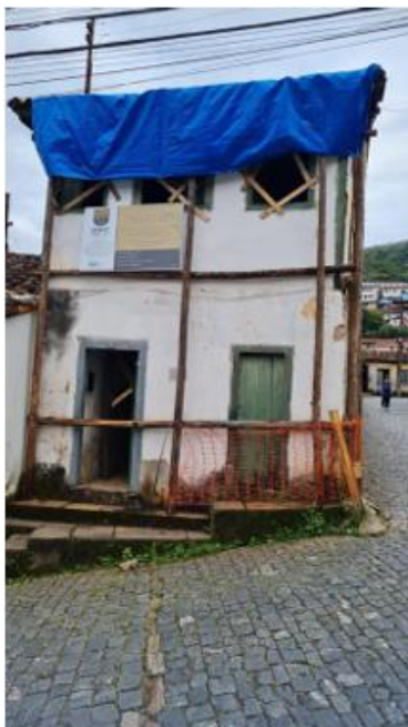
Imagem 2: Fachada principal escorada, 02/2023
