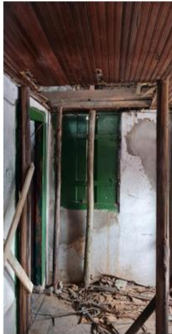
Imagem 14: Pavimento superior, intervenção inadequada, parede de pau a pique, reboco de cimento em parede de pau a pique, 02/2023
