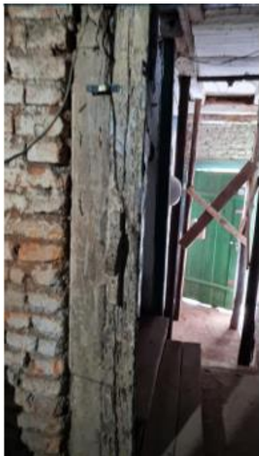
Imagem 35: Estrutura de sustentação no térreo com deterioração avançada, 02/2023
