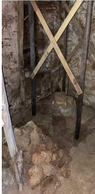
Imagem 10: Piso do porão do térreo de terra batida, 02/2023
