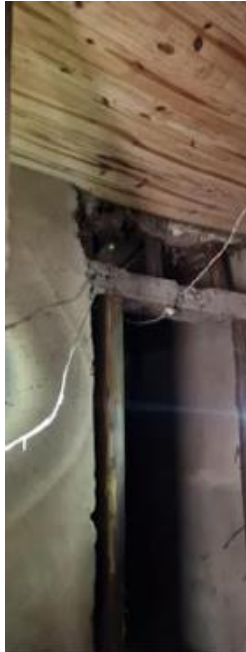
Imagem 9: Forro de madeira (pinus) do quarto no pav. térreo, 02/2023
