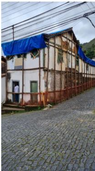
Imagem 3: Fachadas principal e lateral escoradas, 02/2023
