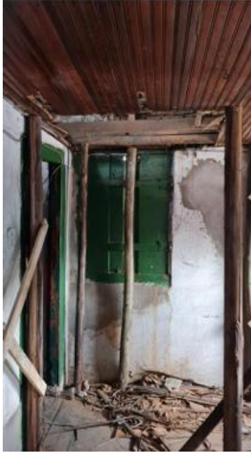
Imagem 19: Pavimento superior, sala, alvenaria em pau a pique, forro de pinus com visível ataque de insetos xilófagos, 02/2023
