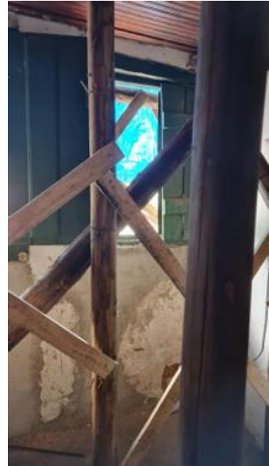
Imagem 15: Pavimento superior, intervenção inadequada, parede de pau a pique, reboco de cimento em parede de pau a pique, 02/2023
