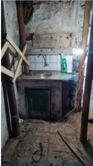
Imagem 16: Pavimento superior, cozinha, alvenarias de tijolo cerâmico, reboco desprendendo causados provavelmente por umidade, 02/2023
