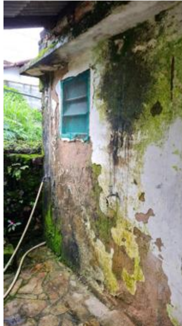
Imagem 17: Pavimento superior, cozinha, alvenarias de tijolo cerâmico, reboco desprendendo causados provavelmente por umidade, 02/2023
