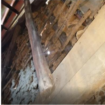
Imagem 13: Pavimento superior, parede de pau a pique em péssimo estado, 02/2023
