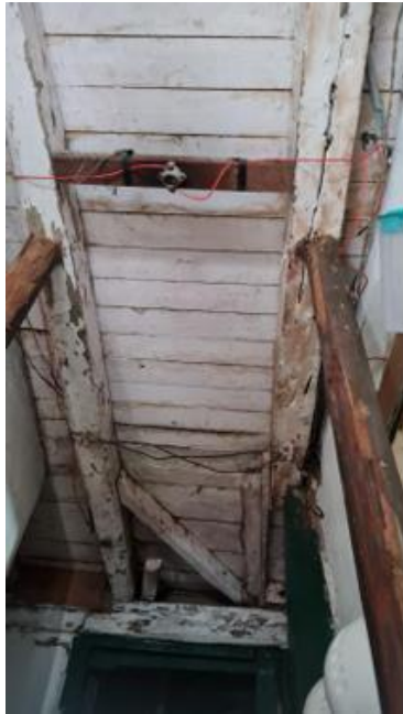
Imagem 36: Instalação elétrica aparente, com risco de curto circuito, 02/2023
