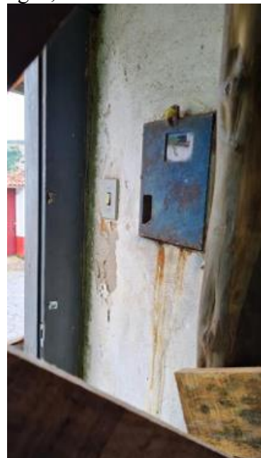
Imagem 37: Quadro de energia elétrica, manchas na parede de escoamento de água, 02/2023
