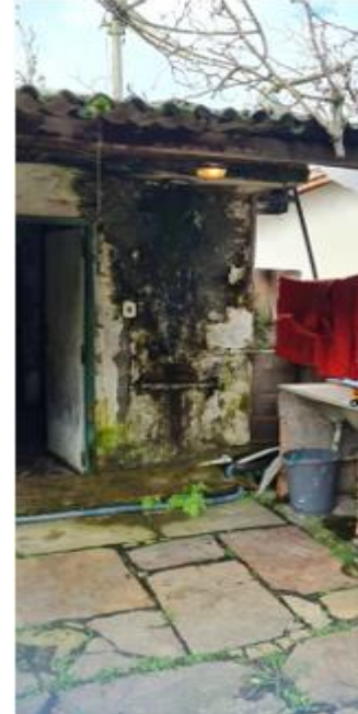
Imagem 18: Pavimento superior, alvenarias de tijolo cerâmico, reboco desprendendo e muito musgos, 02/2023
