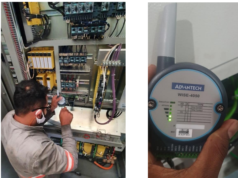
Figura 21 - Instalação do WISE-4050 na máquina de usinagem HELLER
