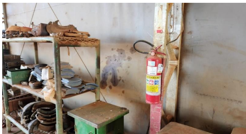
Figura 11 Extintores de incêndio.
