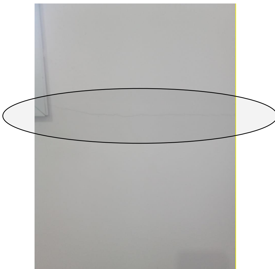
Figura 22 - Fissura apresentada no lavabo
