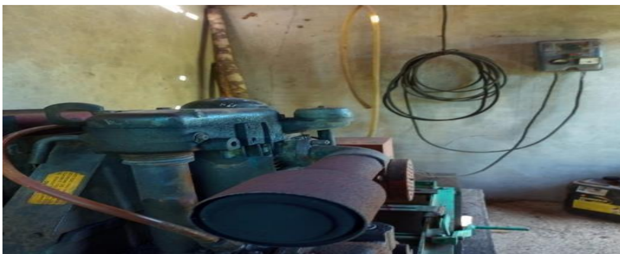
Figura 16 - Sala da Motobomba
