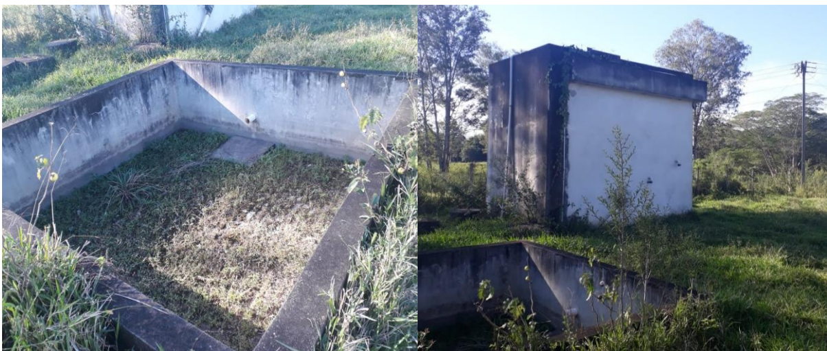
Figura 18 – Estação de Tratamento de Esgoto (ETE) de Tapiraí-MG, em situação de abandono
