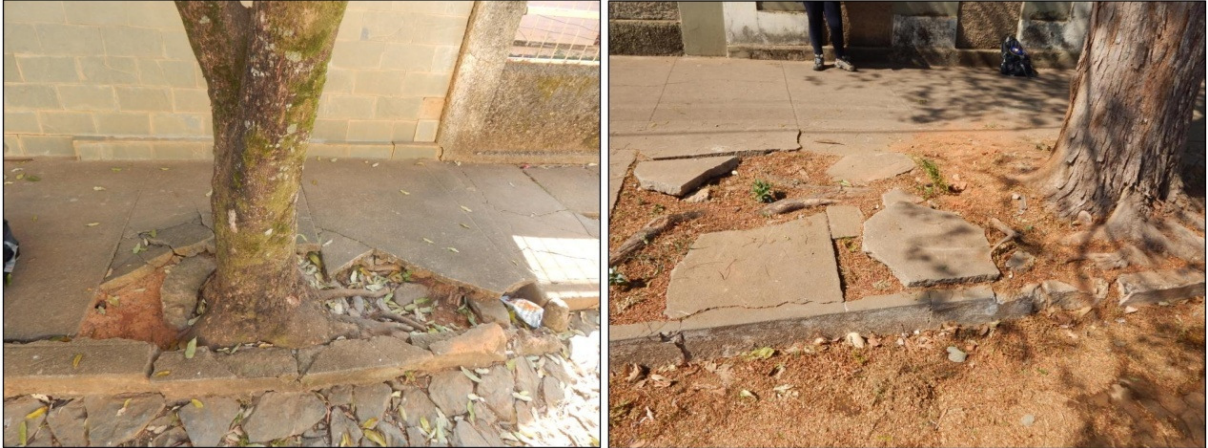
Figura 11 – Danos ao pavimento causados pela arborização urbana de Bambuí – MG
