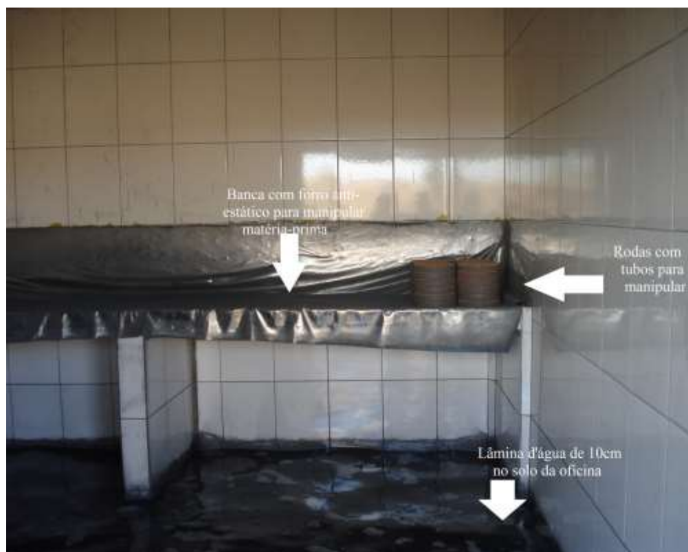
Figura 6 – A oficina de manipulação de pólvora branca contém 10cm de lâmina d'água residuária, para minimizar risco de incêndio e explosão
