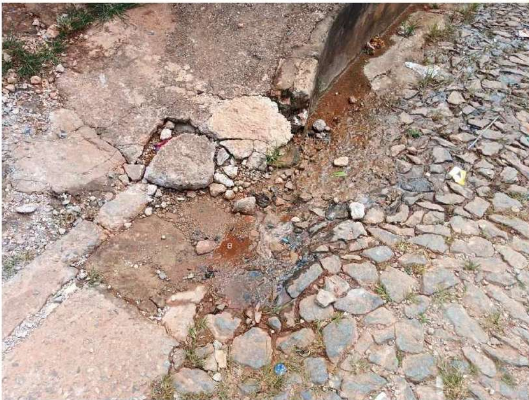
Apêndice 16: Vazamento visível
