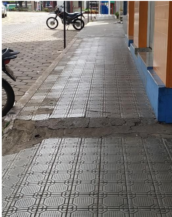
Imagem 6 – Desníveis na calçada D
