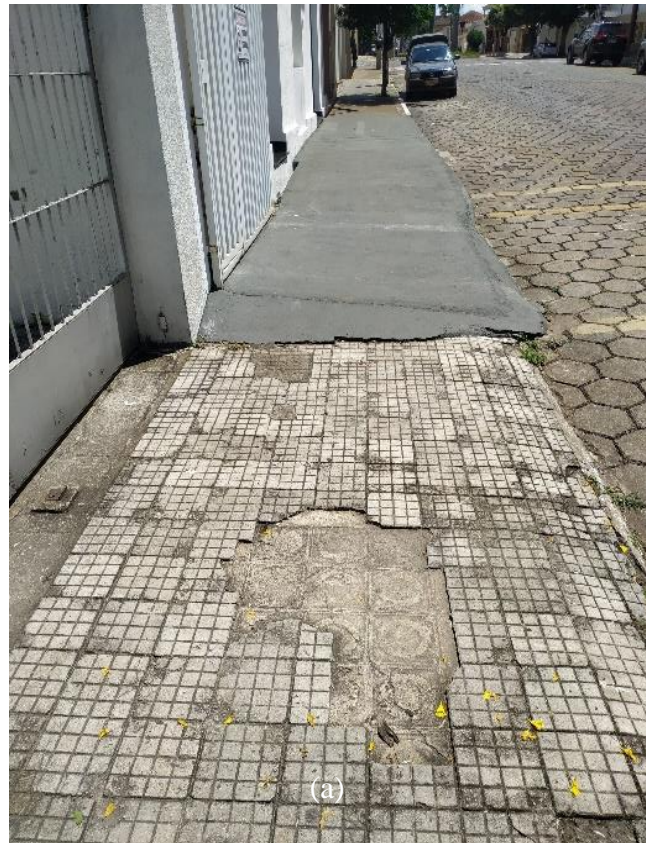
Imagem 2 – Irregularidades na calçada B
