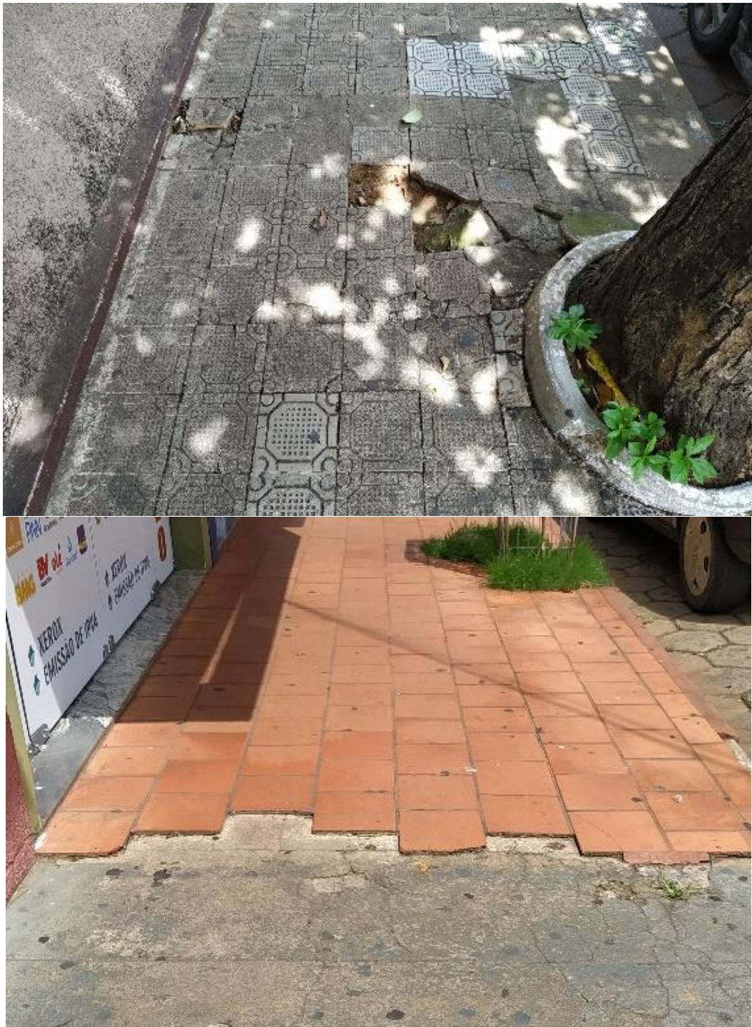
Imagem 27 – Irregularidades na calçada S
