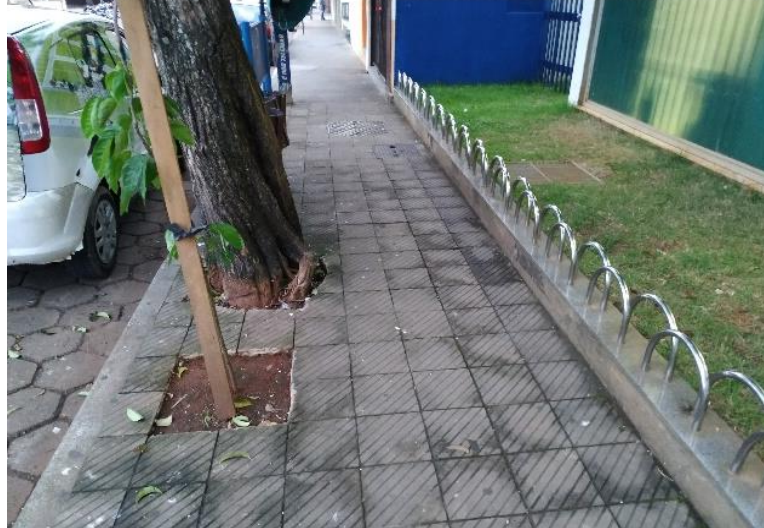
Imagem 25 – Faixa livre reduzida na calçada R
