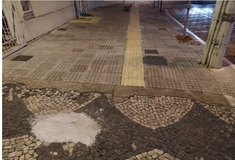
Imagem 21 – Descontinuidade do piso tátil na calçada O
