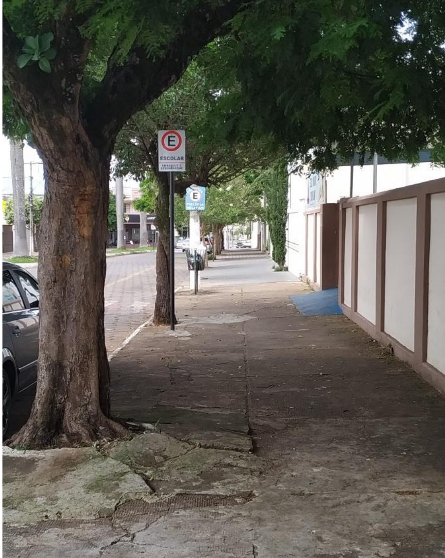
Imagem 1 – Superfície danificada pelas raízes
