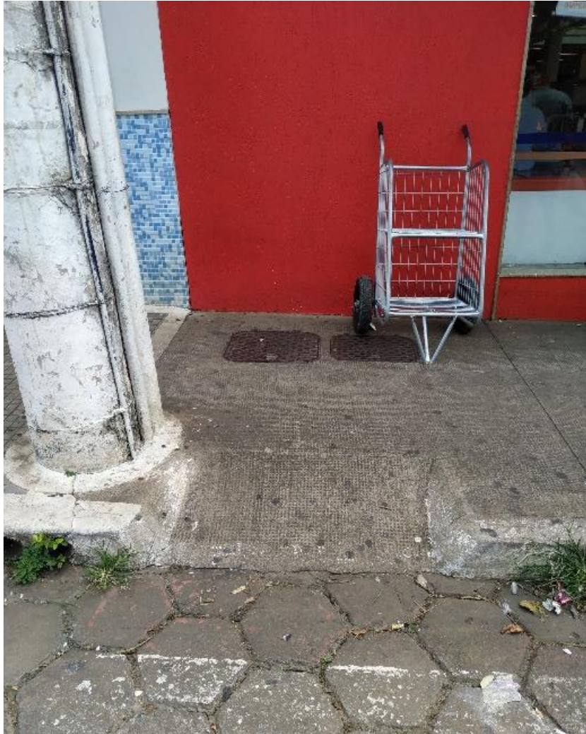
Imagem 16 – Rampa inadequada na calçada K
