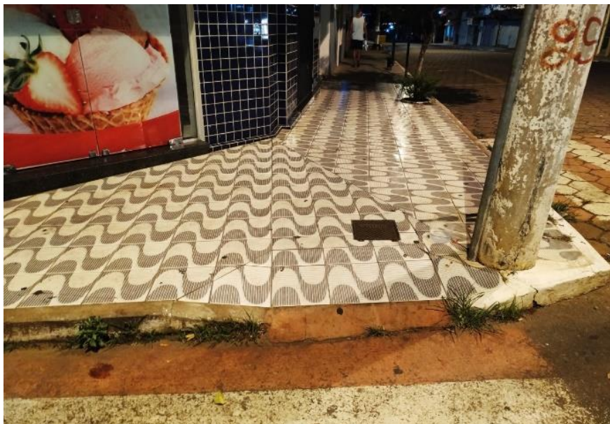
Imagem 18 – Rebaixamento na calçada M
