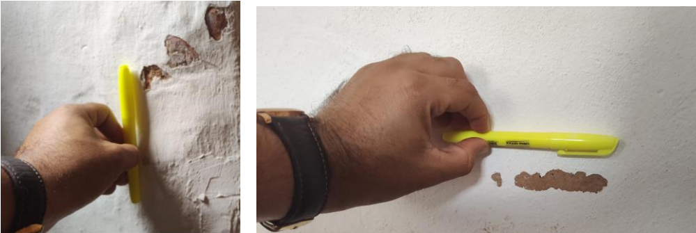
Descolamento da pintura:
