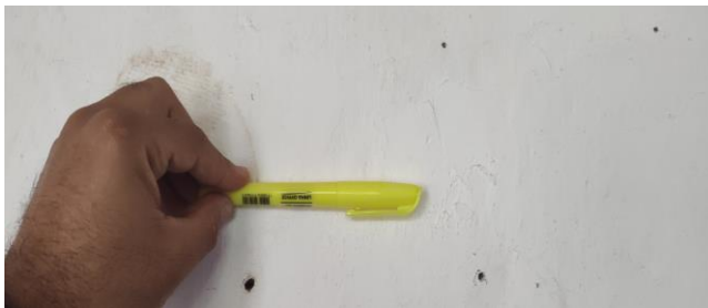
Lacunas do revestimento:
