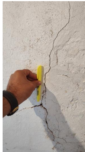
Trincas e fissuras:
