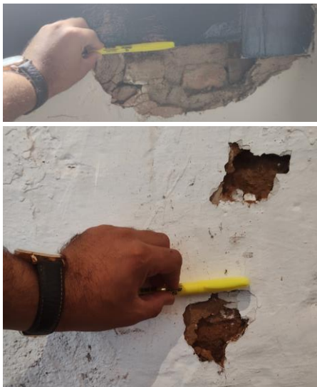
Descolamento do revestimento:
