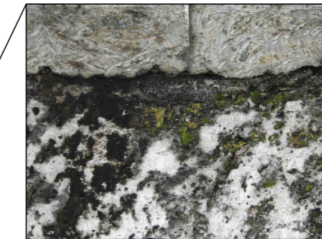
Fig. 12: Base da coluna com crosta negra, biofilme e argamassa cimentícia.
