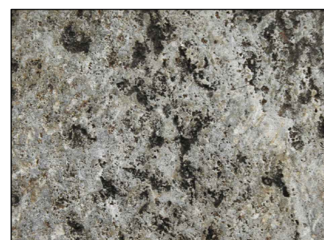
Fig. 1: Base da coluna, com manifestação de crosta negra por toda sua área, principalmente nas cavidades naturais da cantaria. Tal dano se repete ao redor de todas as vistas do objeto em estudo. Há também, intervenções com argamassa cimentícia e resina epóxi nas juntas de encaixe e esquinas.
