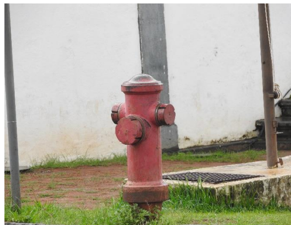
Figura 46: Hidrante no largo da Casa de Câmara e Cadeia. Fonte: Sabrina Delamore, 2017.
