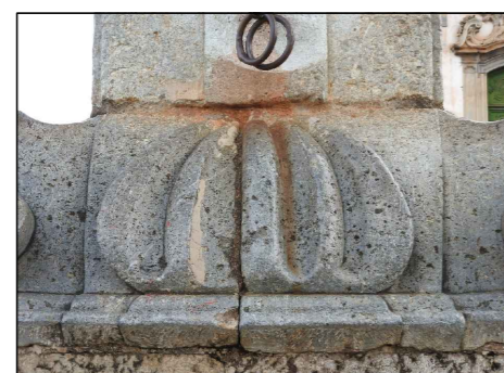
Fig. 2: Na base ornamentada, há locais pontuais com impregnação de crosta negra, resina epóxi e alteração cromática. Nas argolas metálicas, há indícios de oxidação moderada.
