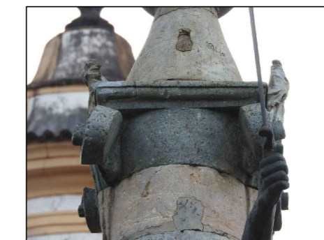
Fig. 10: Junta do arremate da coluna com intervenção em argamassa cimentícia, resina epóxi e fissuras ocasionadas pela própria intervenção.
