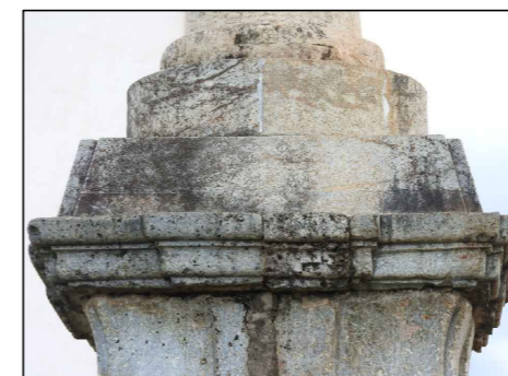
Fig. 9: Soco da coluna com grande impregnação de crosta negra e intervenções pontuais com resina epóxi. Tal dano repete-se ao redor de todas as vistas do elemento.
