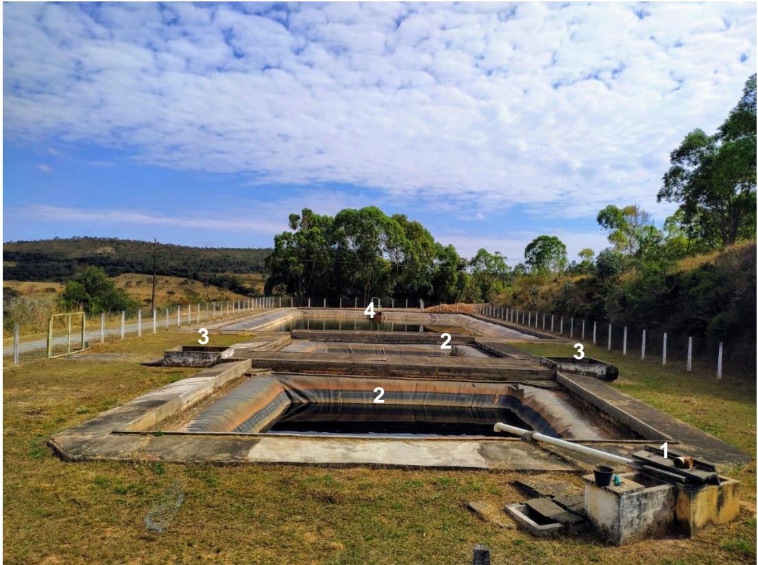
Figura 10 – Vista geral do 1º Módulo de Tratamento de Chorume
