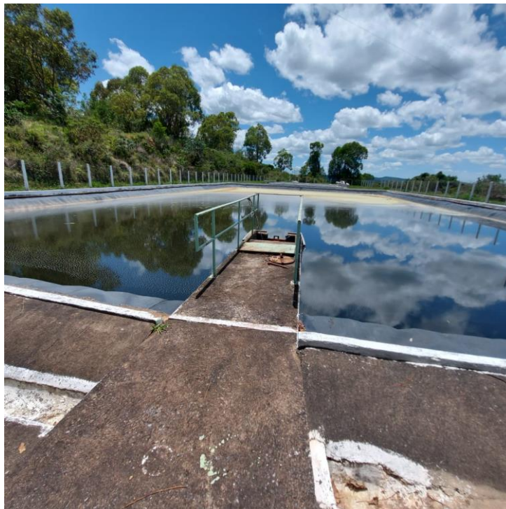
Figura 12 – Lagoa facultativa com capacidade para 1.940 m 3 e profundidade de 2 metros
