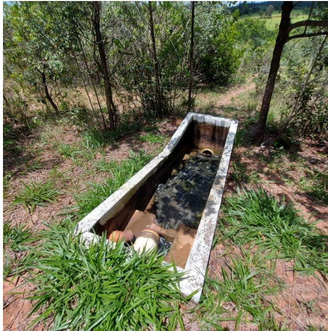
Figura 13 – Escada de aeração
