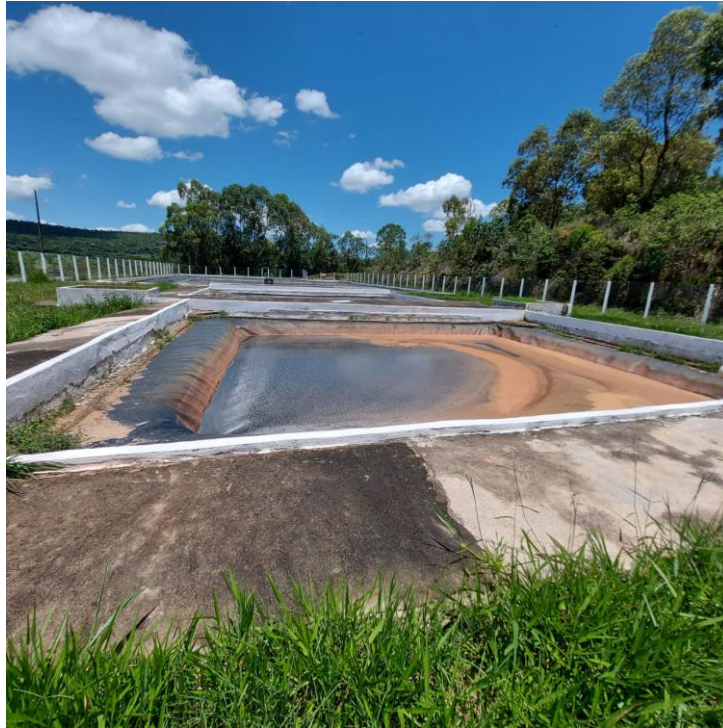
Figura 11 – Lagoa anaeróbia com capacidade para 205,00 m 3 e profundidade de 4 metros
