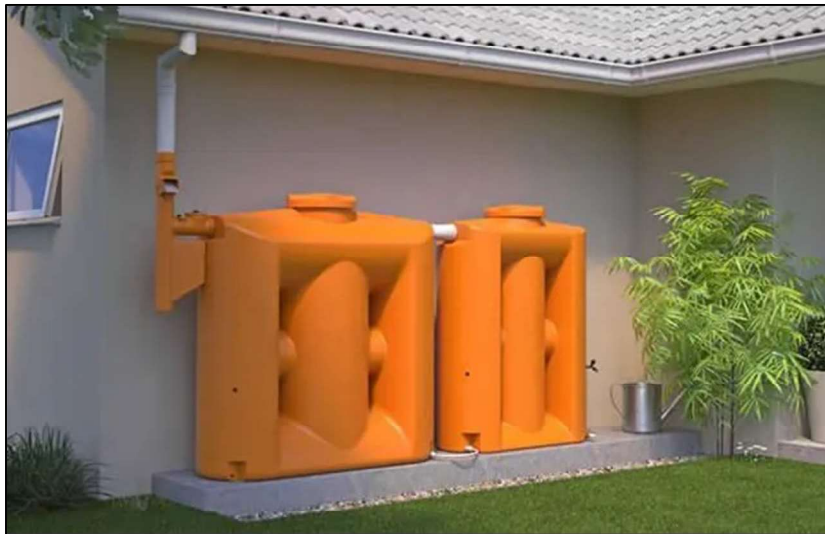
Figura 6 - Reservatório para água de chuva – micro reservatório individual
