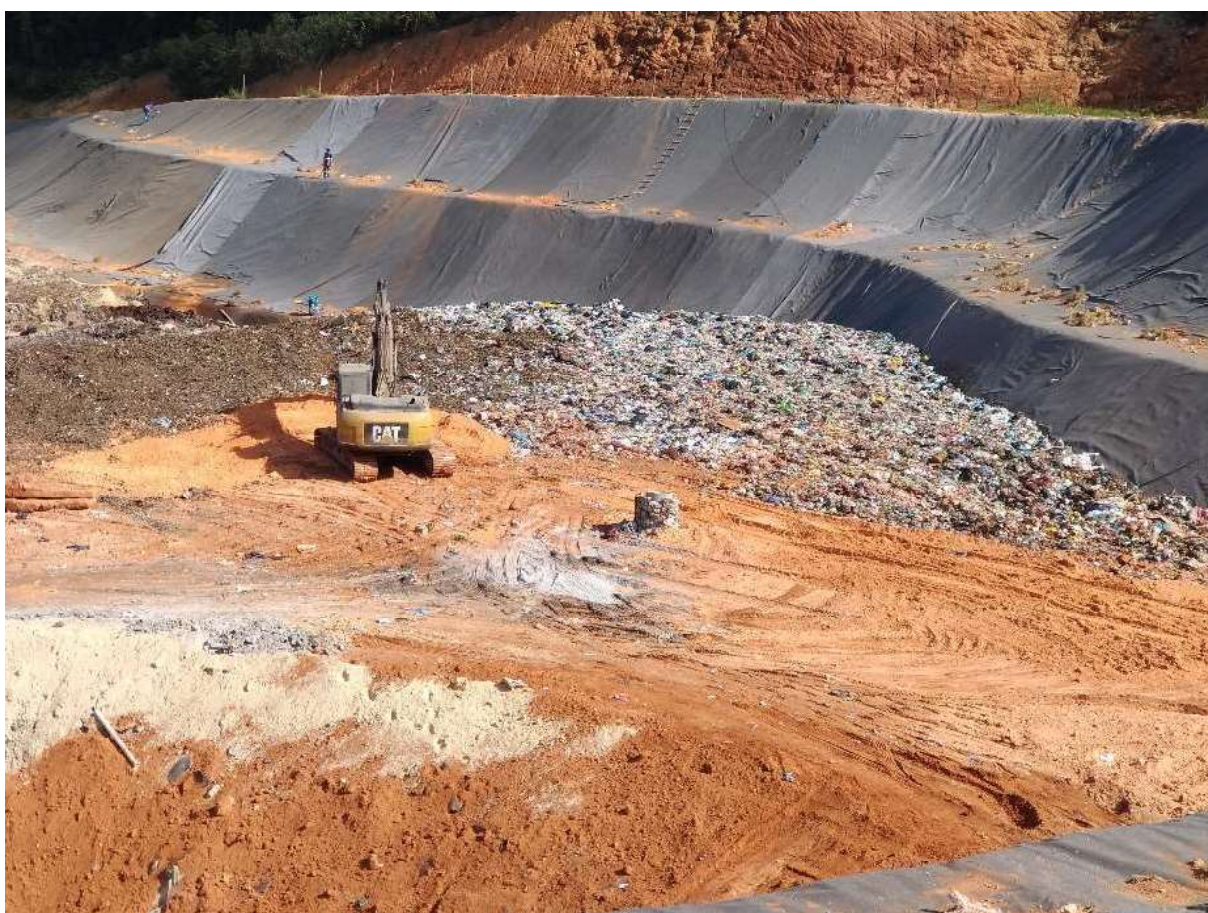
Figura 09 – Equipamentos para processamento de resíduos
