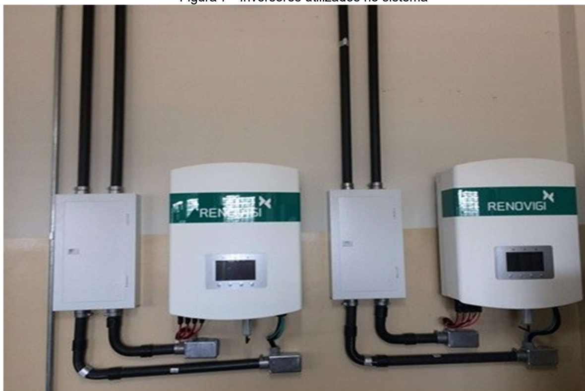
Figura 7 - Inversores utilizados no sistema
