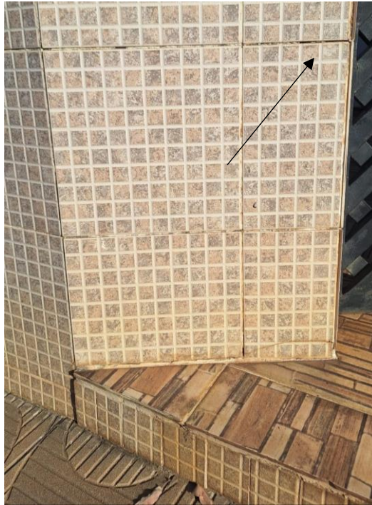
Figura 10: Ausência de rejunte devido a penetração da água. Fonte: Autoras (2023)
