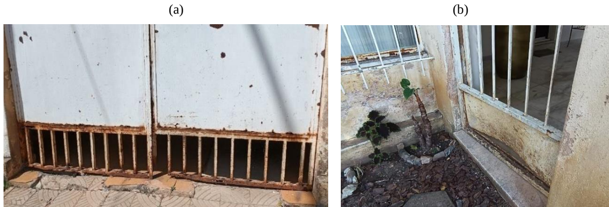
Figura 12 (a);(b): Danos em elementos metálicos. Fonte: Autoras (2023)
