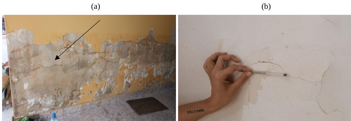
Figuras 04 (a);(b): Trincas e fissuras Fonte: Autoras (2023)
