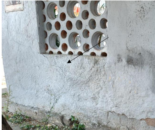
Figura 05: Trinca por recalque Fonte: Autoras (2023)
