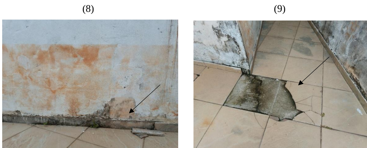
Figuras 08 e 09: Deslocamento de revestimentos. Fonte: Autoras (2023)
