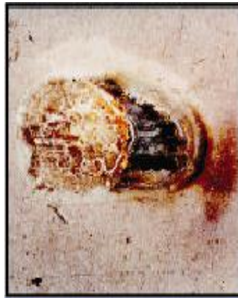
Figura 16: Defeito de escorregamento
