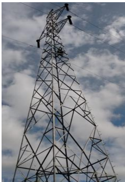
Figura 11: Estrutura autoportante com cadeia de isoladores do tipo suspensão.
