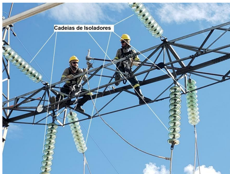
Figura 16: Cadeias de isoladores de vidro.
