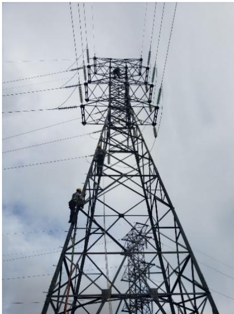
Figura 10: Estrutura autoportante com cadeia de isoladores tipo ancoragem.
