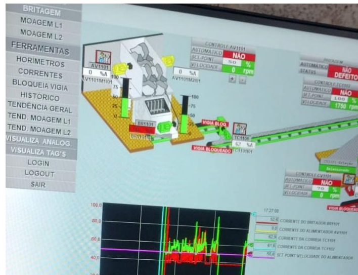
Figura 18 - Sistema Supervisório desenvolvido
