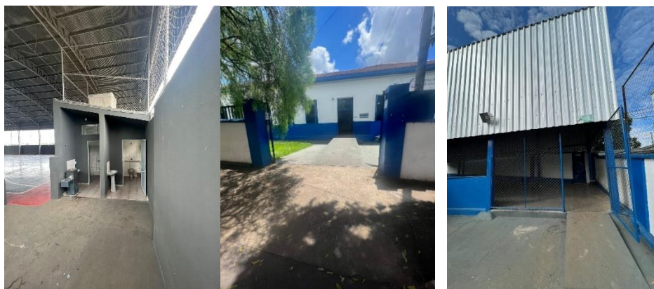
Figura 10 - Rampas sem proteção vertical encontradas nas escolas B, G e G respectivamente
