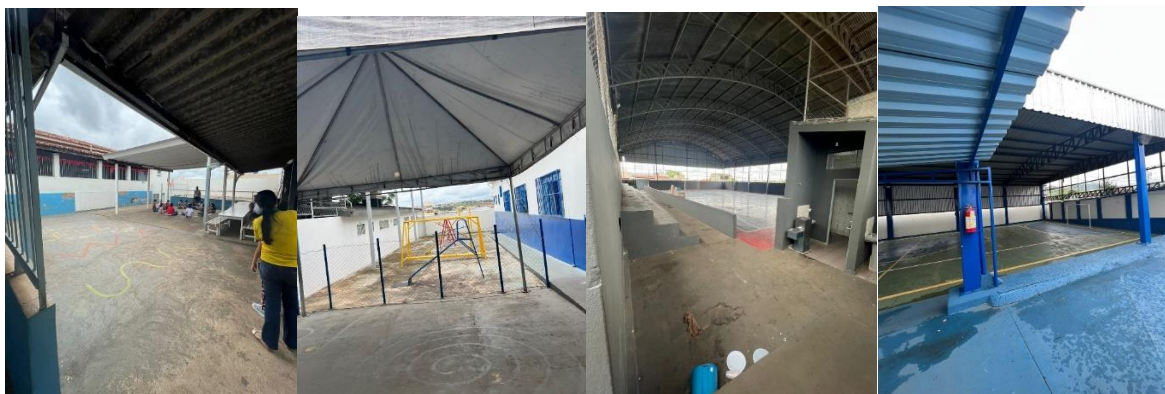
Figura 24 - Tipos de acessos as quadras poliesportivas e espaços de recreação nas escolas C, B, B e F respectivamente
