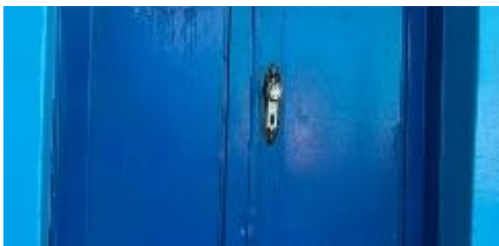
Figura 16 - Modelo de maçaneta inadequada da escola A.
