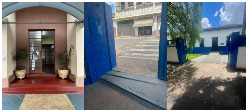
Figura 6 - Irregularidades encontradas nos acessos às edificações das escolas D, F e G respectivamente
