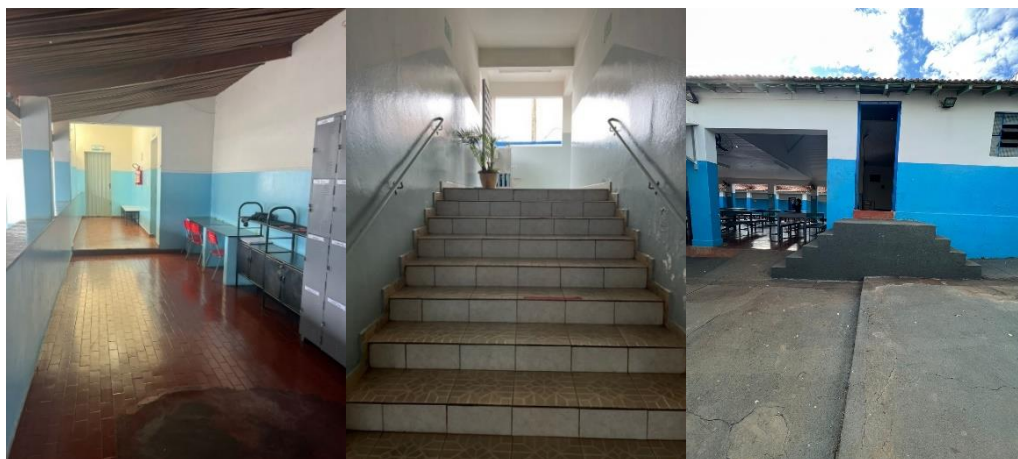
Figura 8 - Irregularidades encontradas nas áreas de circulação da Escola C, F e G respectivamente
