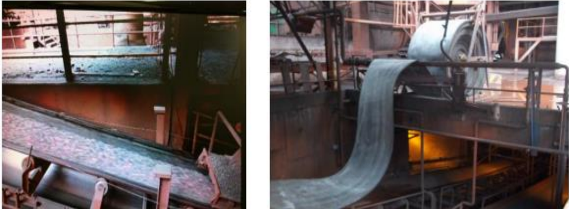
Figura 10 - Correia transportadora de alta temperatura.
