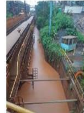
Obstrução da canaleta do TCLD proveniente da queda de material por desalinhamento. Um turno inteiro para regularizar situação. Risco de Queima do motor 2.
