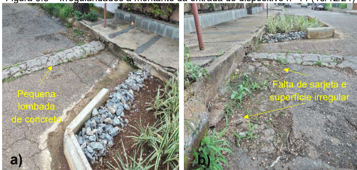
Figura 6.3 – Irregularidades a montante da entrada do dispositivo nº 14 (15/12/24)
