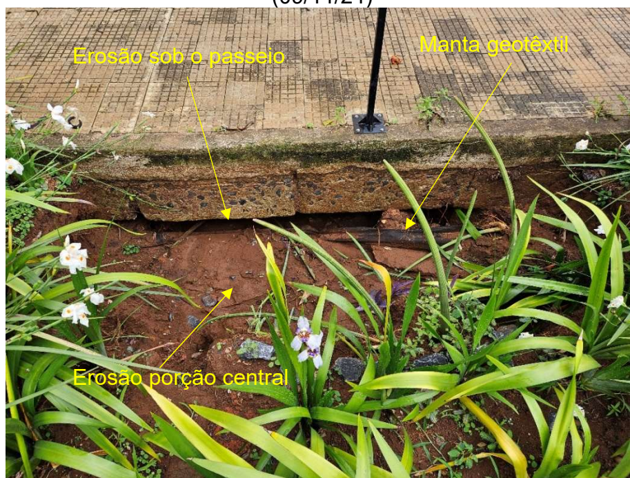
Figura 6.10 – Ocorrência de erosão na porção central do jardim de chuva nº 2 (09/11/24)
