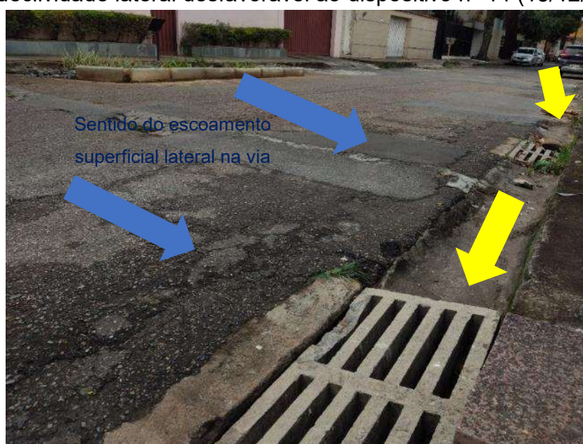
Figura 6.4 – Sistema de drenagem convencional no lado oposto ao jardim de chuva e declividade lateral desfavorável ao dispositivo nº 14 (15/12/24)
