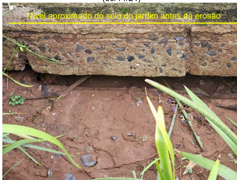
Figura 6.11 – Detalhe da erosão sob o passeio ao lado do jardim de chuva nº 2 (09/11/24)
