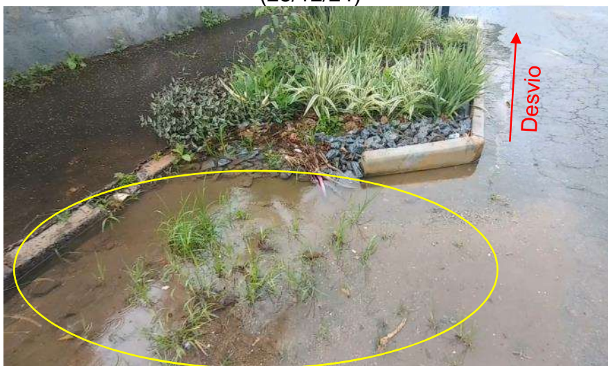
Figura 6.7 – Detalhe no acúmulo de água na entrada do jardim de chuva nº 1 (28/12/24)
