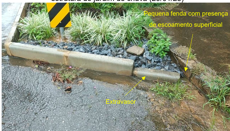
Figura 6.19 – Detalhe do extravasor com uma altura menor que à altura das guias da estrutura do jardim de chuva (29/01/25)
