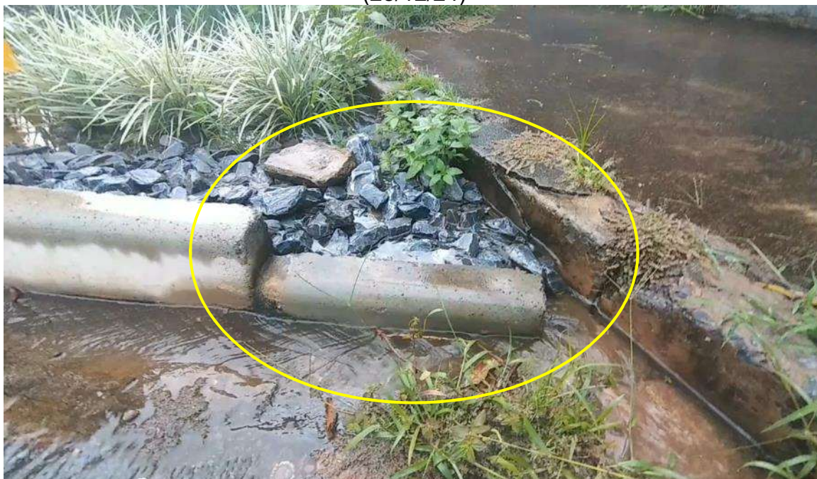
Figura 6.15 – Detalhe da saída do jardim de chuva nº 1 com escoamento superficial (28/12/24)
