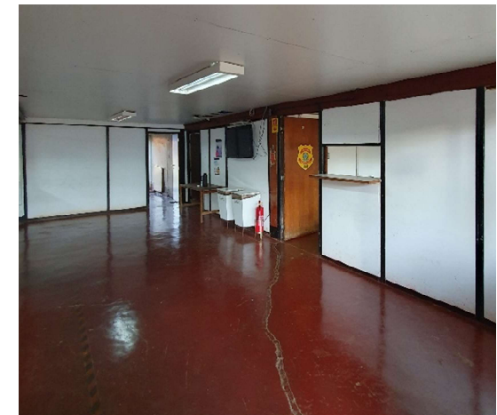
Interior da Edificação OCA II, pavimento Térreo – UNB em Brasília – Sérgio Rodrigues. Fonte: Acervo da autora, 2023.
