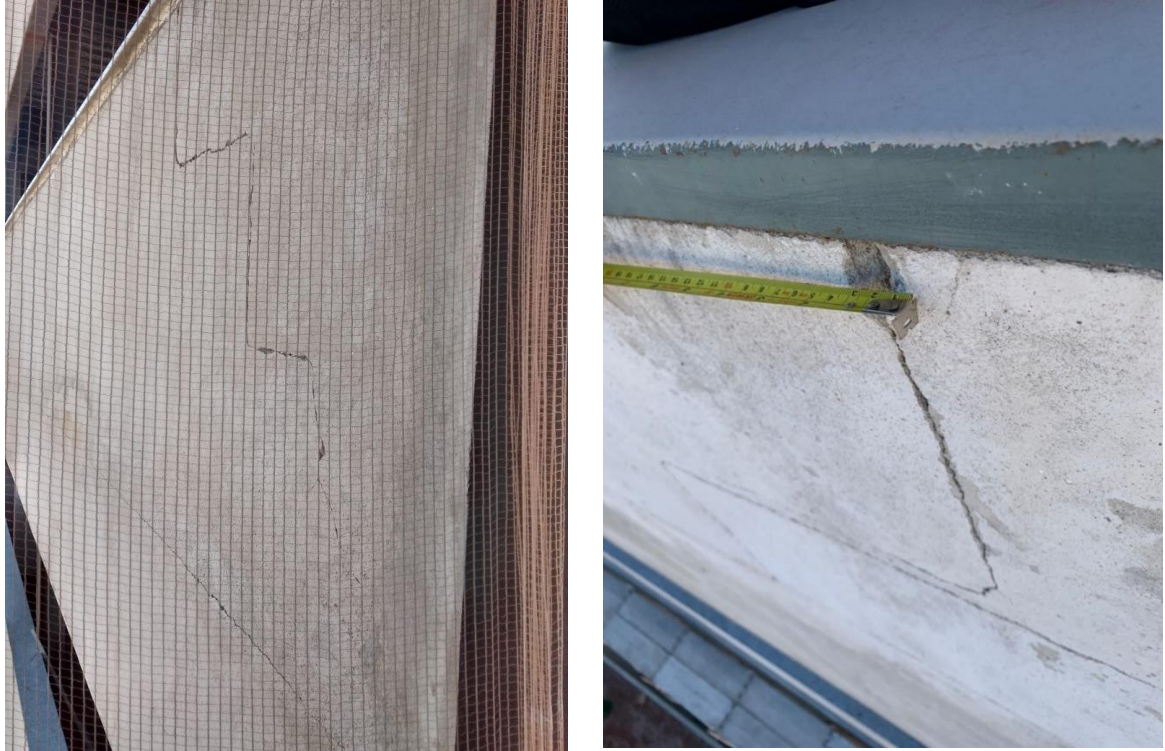
Figura 15: Rachaduras e Fendas
