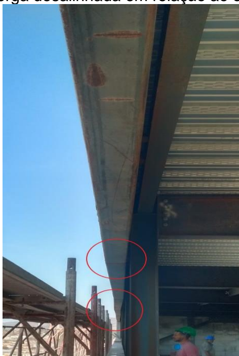
Figura 10: Verga desalinhada em relação ao eixo horizontal
