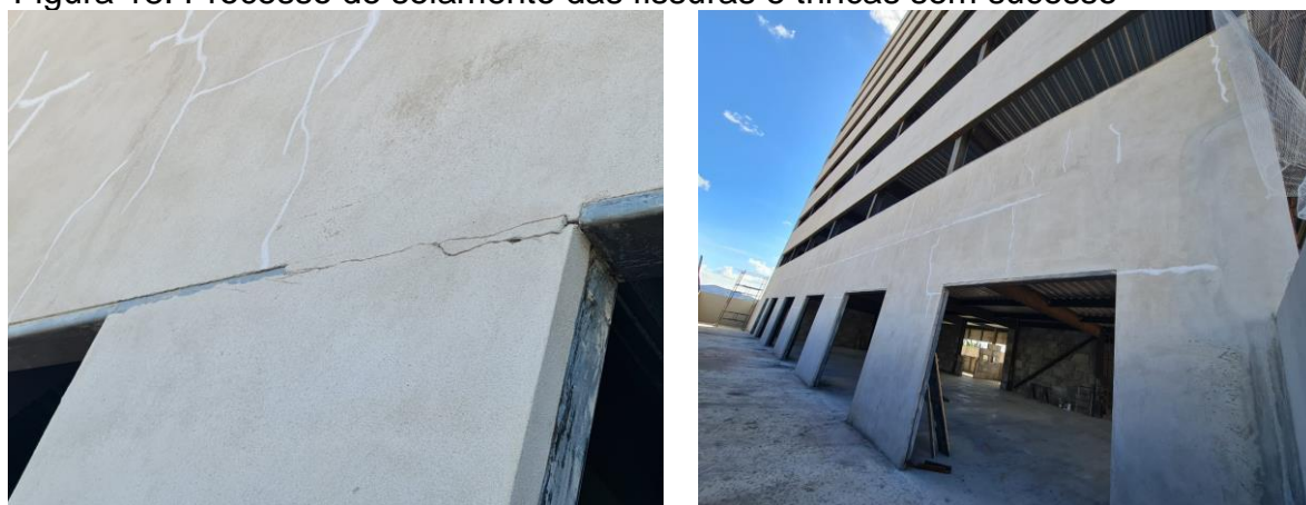
Figura 18: Processo de selamento das fissuras e trincas sem sucesso
