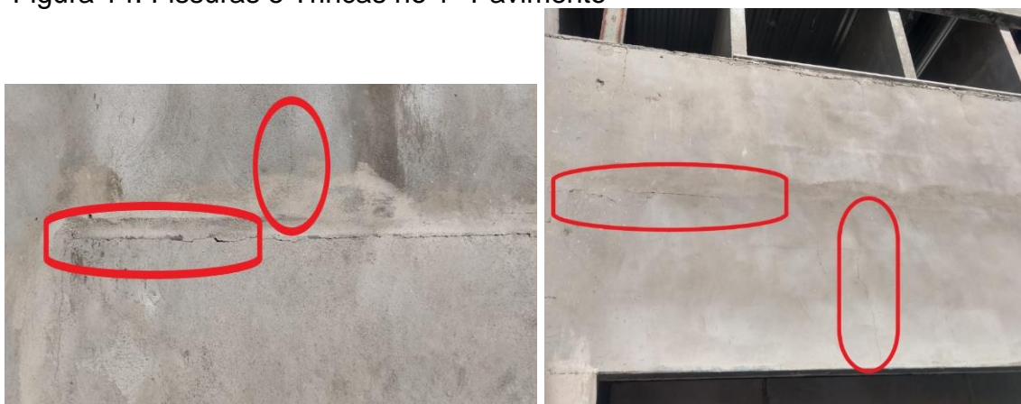
Figura 14: Fissuras e Trincas no 1º Pavimento
