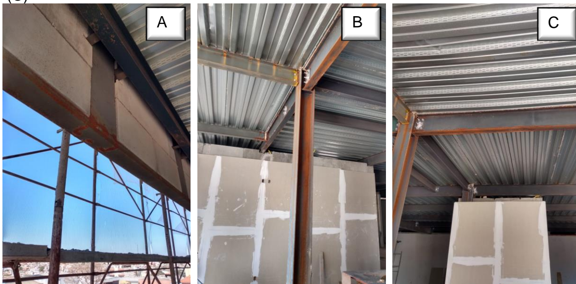
Figura 26: Corrosão em ponto de solda de vergas (A), pilares (B) e vigas estruturais (C)
