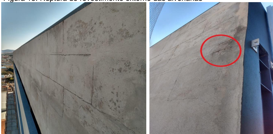
Figura 13: Ruptura do revestimento externo das alvenarias
