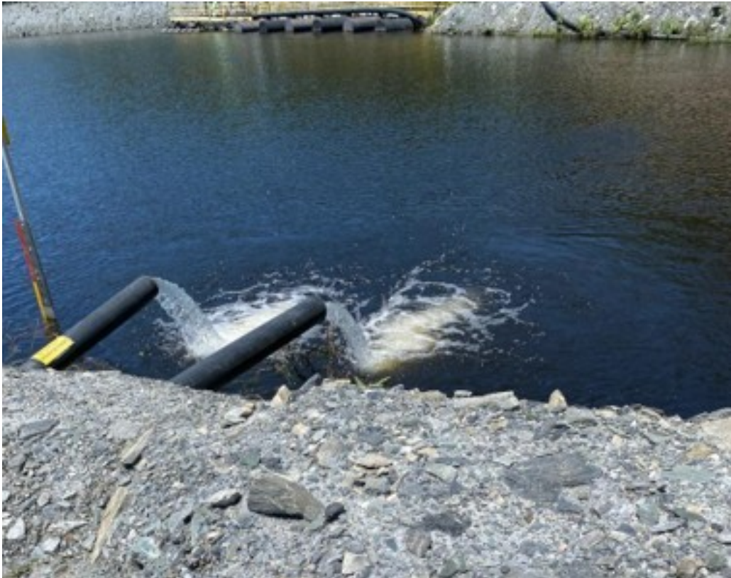
Figura 15 – Retorno do efluente do dreno de fundo na barragem.
