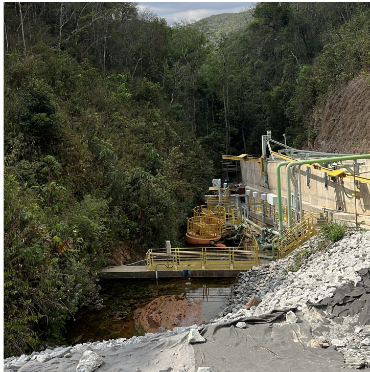
Figura 14 – Dreno de fundo de uma barragem de rejeitos de mineração de ouro.
