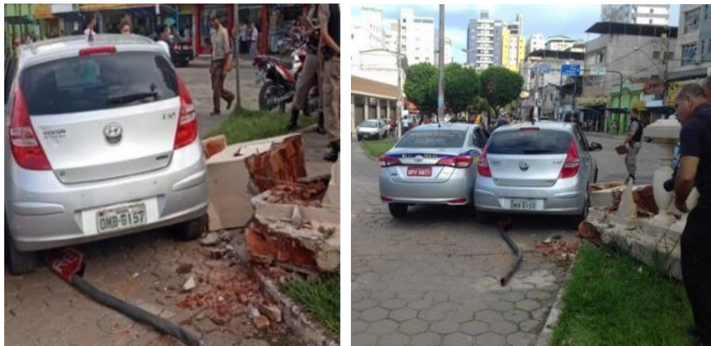
Figuras 46 e 47: Tentativa de ultrapassagem danifica novamente a balaustrada em 2019
