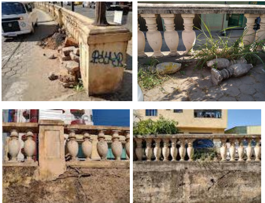
Figuras 49, 50, 51, 52, 53, 54, 55 e 56: Atual estado de conservação da balaustrada
