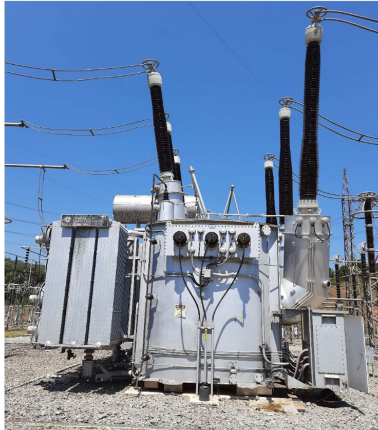
Figura 20 - Transformador preservado após atuação das proteções
