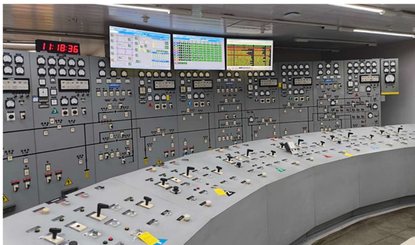
Figura 15 - Sala de controle
