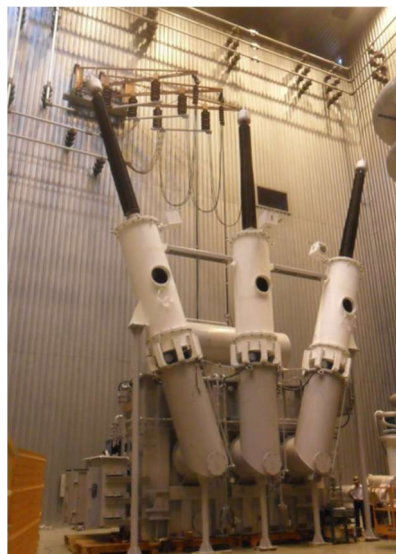
Figura 2 - Transformador de 440kV -122MVA
