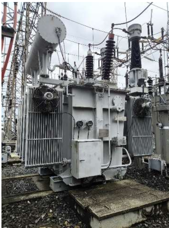
Figura 3 - Transformador de 1975, Subestação de Angra dos Reis - RJ
