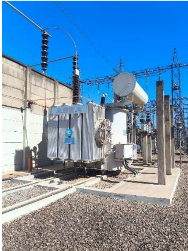
Figura 4 - Transformador de 1976, Barro Alto - Go
