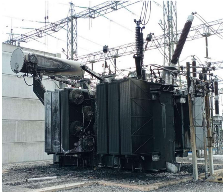
Figura 19 - Transformador incendiado durante curto-circuito
