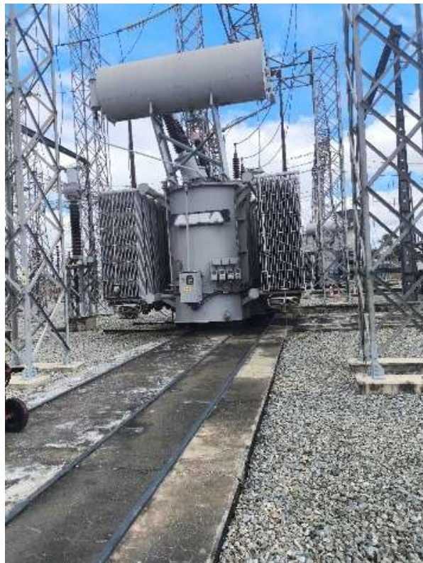
Figura 5 - Transformador de 1976, Itabaiana - SE
