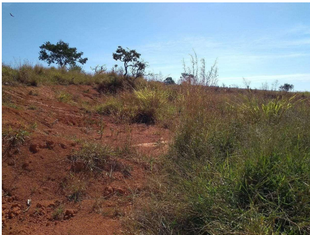
Figura 45 – Processo erosivo no maciço de compactação e aterramento
