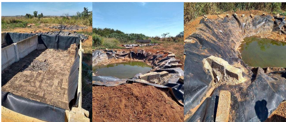
Figura 35 – Estruturas clandestinas para tratamento de esgoto
