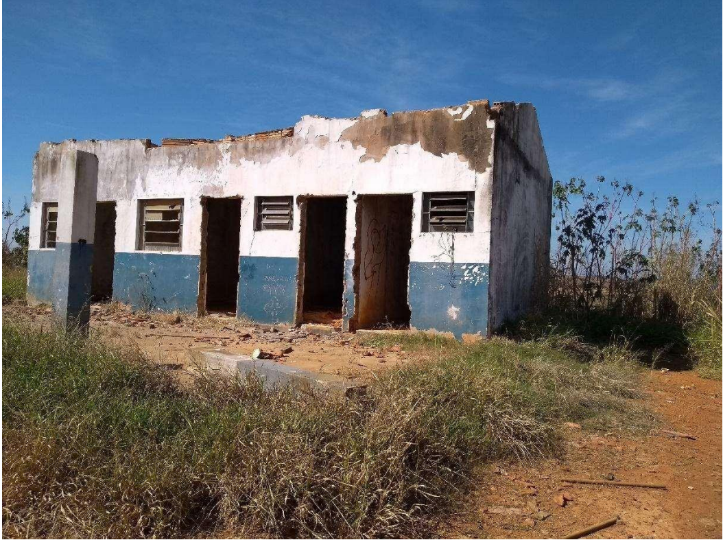
Figura 55 – Edificação de apoio deprecada
