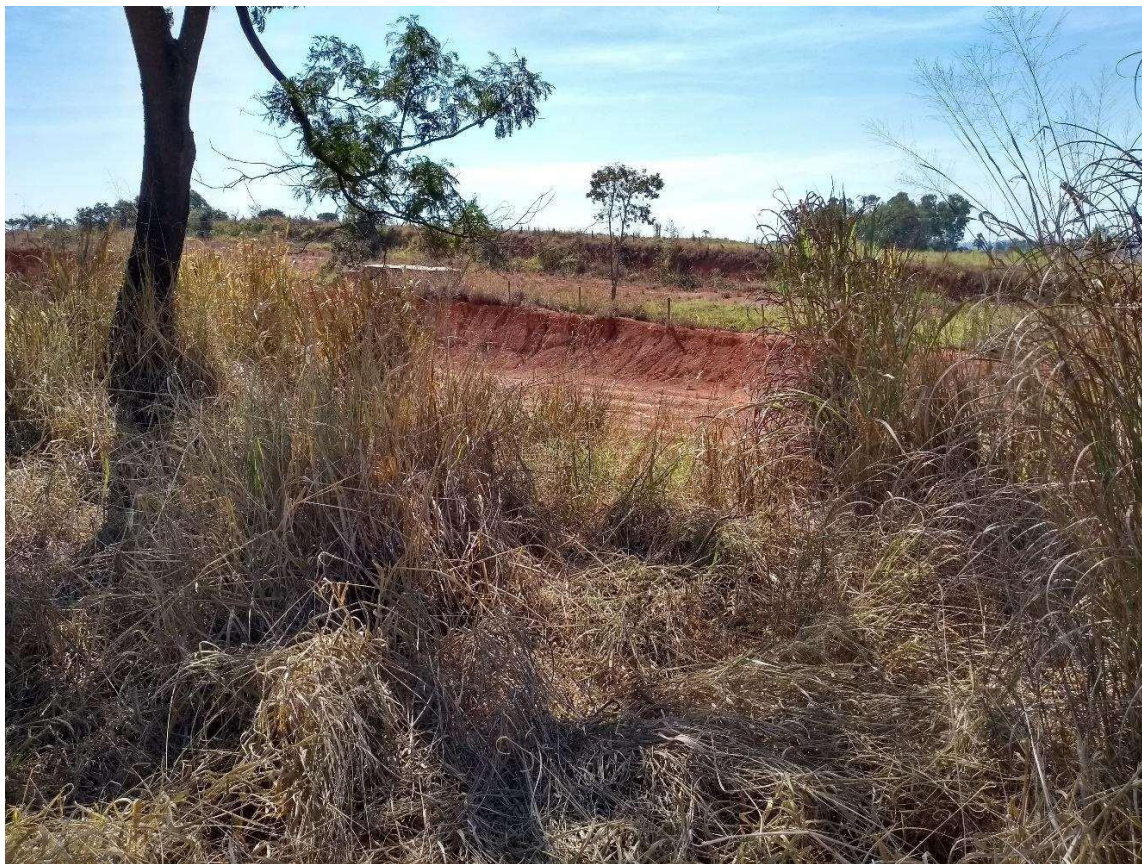
Figura 47 – Processo erosivo em área de empréstimo próximo à rodovia
