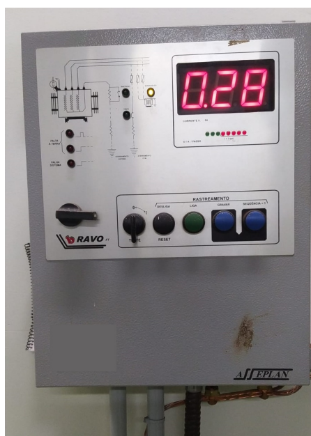
Figura 7 – Sistema digital de Supervisão e Operação do Equipamento (bRAVO)
