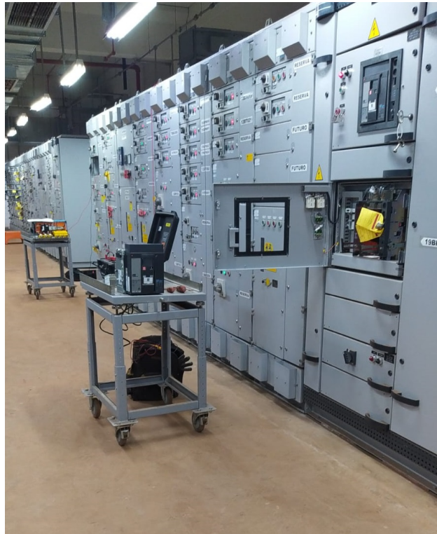
Figura 15 – Centro de Controle de Motores (CCM)
