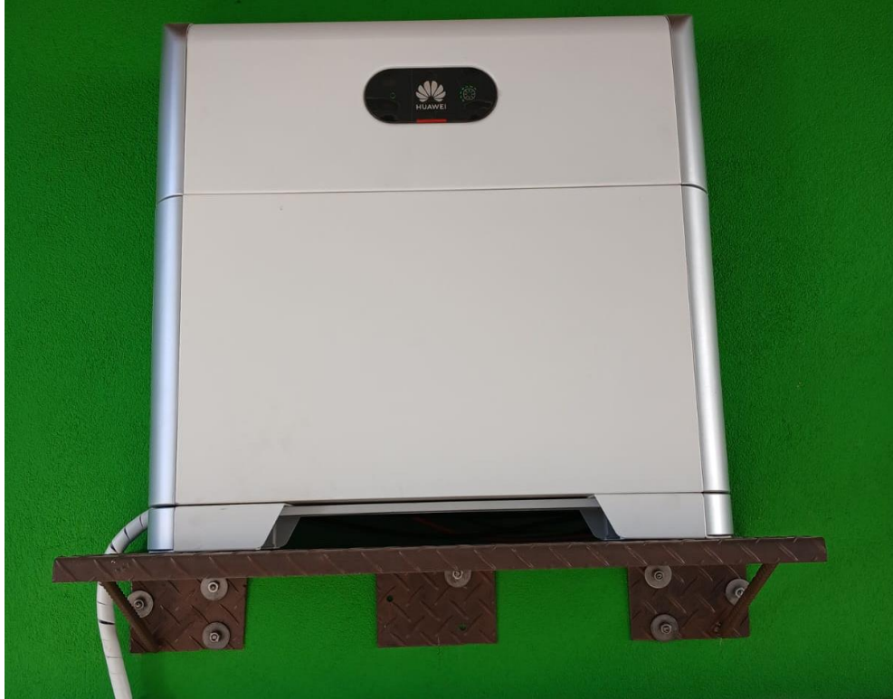
Figura 22 - Bateria Huawei LUNA2000-5-S0 de 5 kWh
