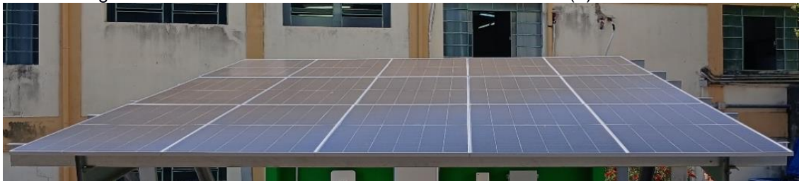
Figura 20 - Módulos fotovoltaicos Sunova SS-585-72MDH(T) de 585 W
