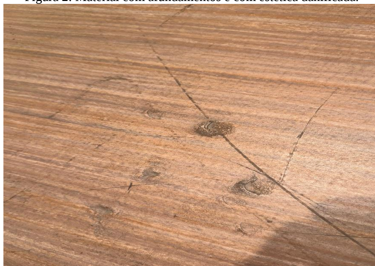
Figura 2: Material com afundamentos e com estética danificada.
